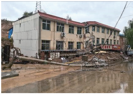
图 9 2#滑块前部拱起及破坏楼房
