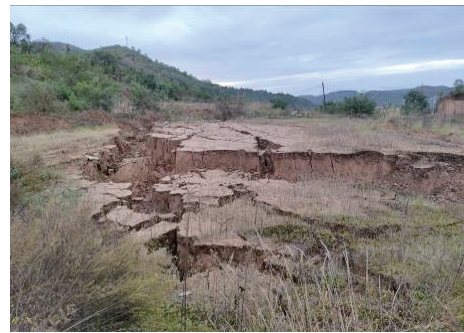
图 7 1#、2#滑块之间裂缝及地面拱起
