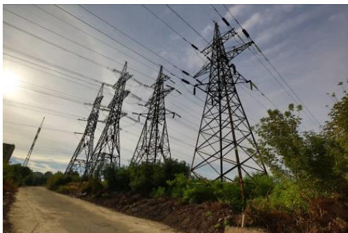
Рис.3. Группа воздушных линий электропередачи вблизи жилых домов. 3
