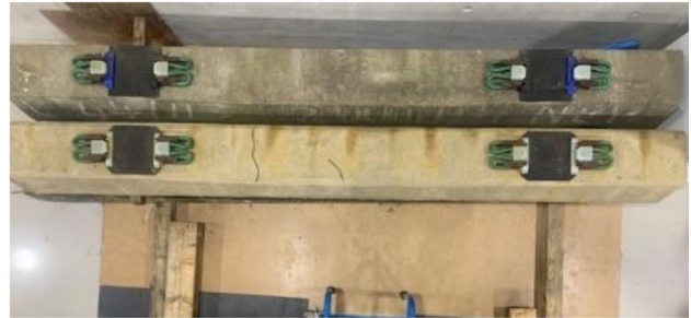
b) transverse cracks
