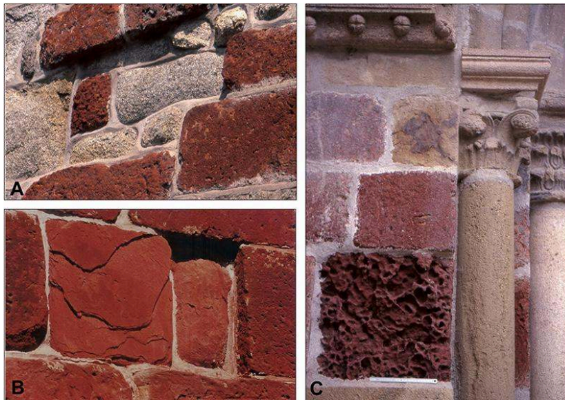
Fig. 2. Formes de dégradation du patrimoine médiéval : A. Désagrégation granulaire des granites leur donnant un aspect émoissé, église de Saint-Dier-d'Auvergne, Puy-de-Dôme, XII e siècle ; B. Desquamation des grès rouges du chevet de l'église Saint-Pierre de Collonges-la-Rouge, Corrèze, XII e siècle ; C. Alvéolisation d'une pierre remployée, Saint-Jacques-le-Majeur, Villefranche-d'Allier (cl. M.-F. André).
