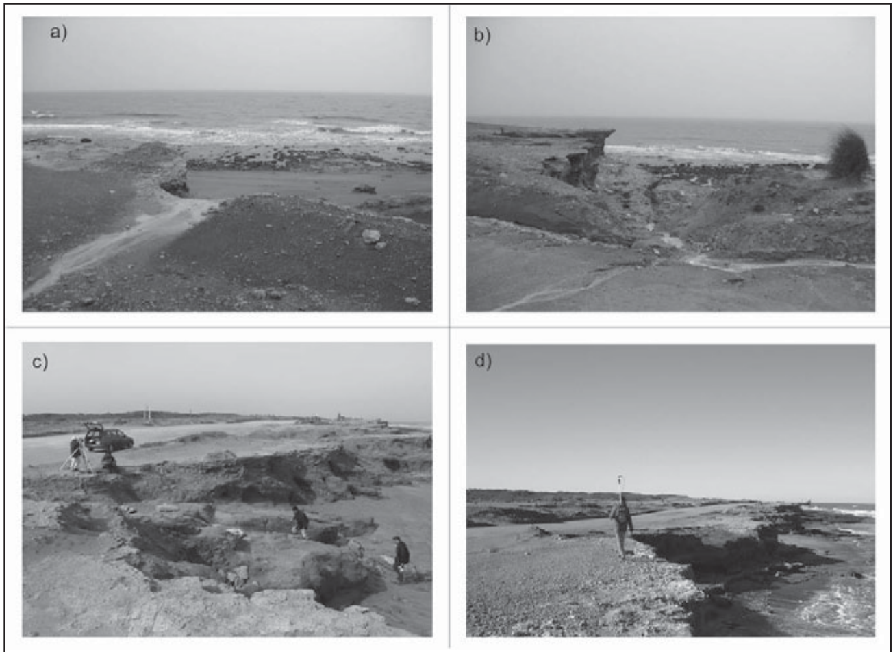
Figura 9. Cárcavas que potencian el retroceso del acantilado: a) y b) Cárcavas en camino costero entre perfiles 7 y 8, c) Perfil 7, d) Acantilado y media caña en las proximidades del Perfil 7.
