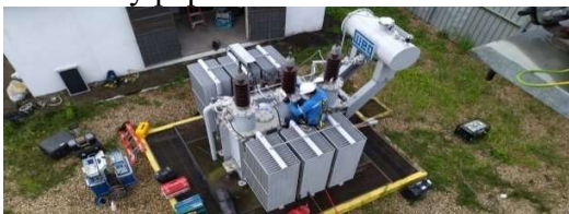
Figura 5. Pruebas eléctricas y toma de muestra de aceite al transformador [Autor].
