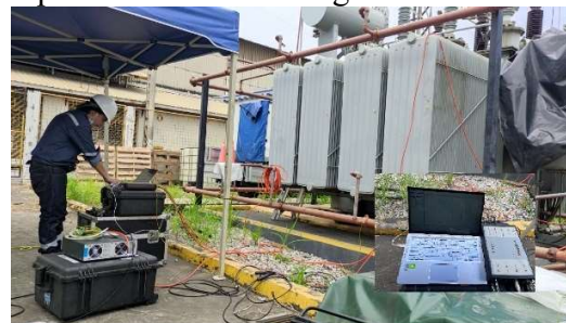
Figura 6. Pruebas eléctricas del transformador [Autor].
