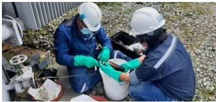
Figura 27. Toma de muestra de aceite al transformador [Autor].
