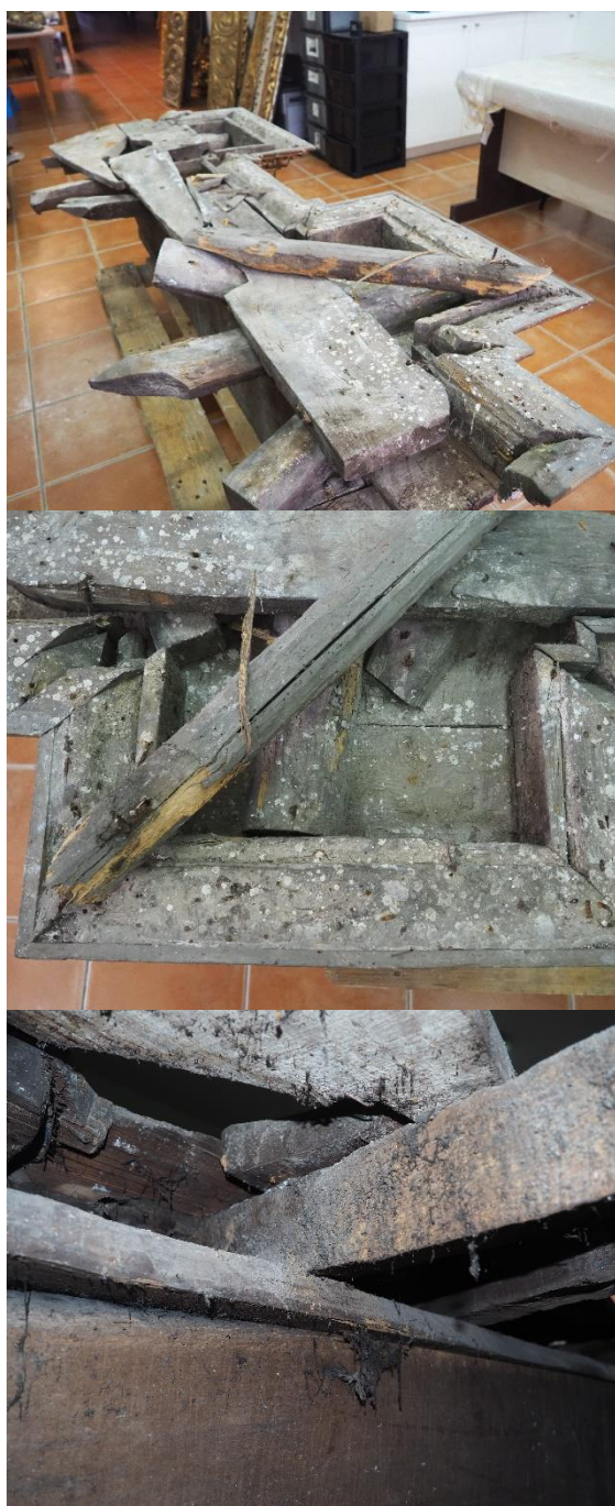
Figura 245 - Verso do entablamento antes da intervenção.
