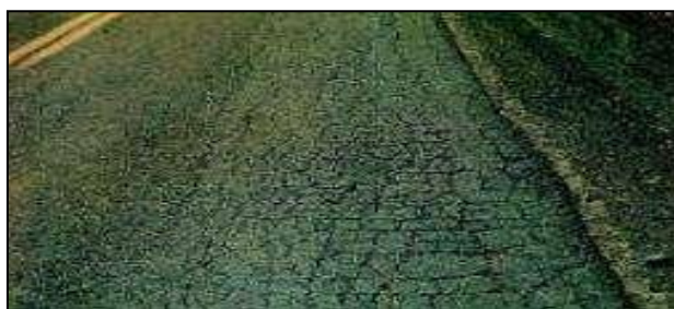
Figura 12: Pavimento asfáltico que presenta grietas por fatiga
