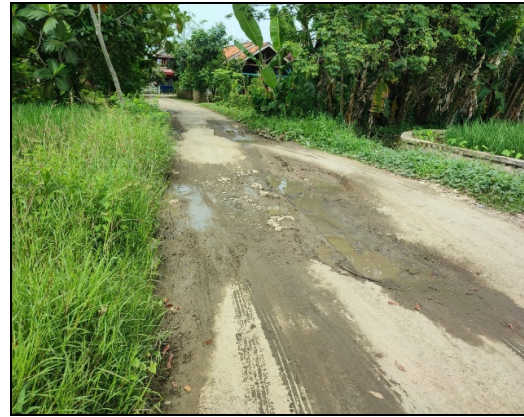
Gambar 2. Kondisi jalan Desa Malangsari
