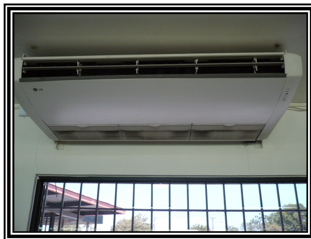
Figura N° 21: Aire acondicionado cerca de un ventanal.
