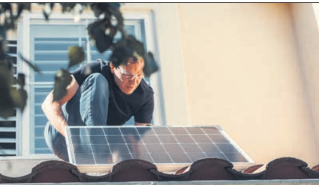
Im neuen Jahr werden viele Richtlinien und Gesetze im Bereich Strom/Heizungen geändert. So müssen Balkon-Solaranlagen nicht mehr beim Netzbetreiber angemeldet werden. Foto: pexels.com
