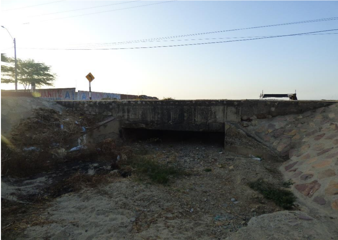
Fotografía 26. Alcantarilla colmatada bajo la vía Panamericana Norte en el sector Punta Mero, distrito de Canoas de Punta Sal.
