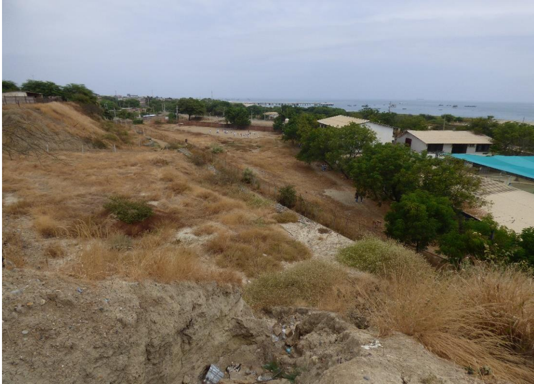
Fotografía 17. Centro Educativo afectado por un deslizamiento, además por procesos de erosión de laderas, A.H. Las Malvinas, La Cruz.
