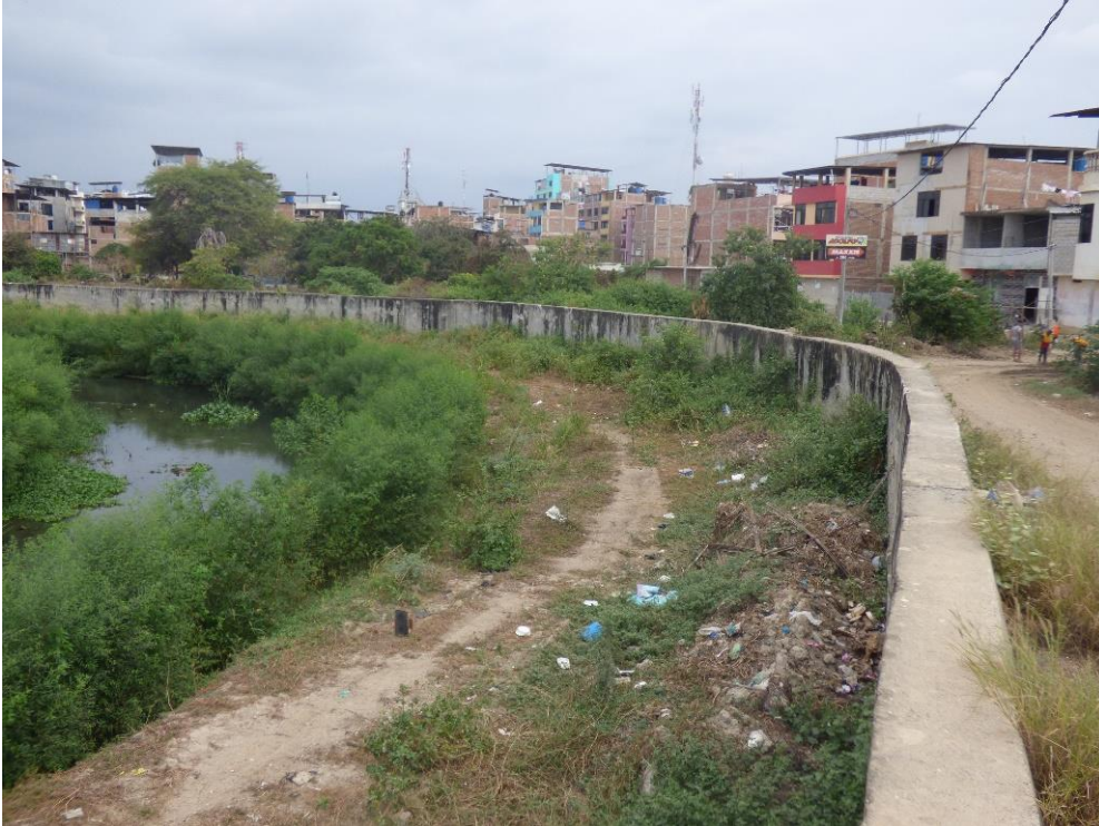
Fotografía 1. Zona afectada por inundación fluvial del Canal Internacional. Los muros de contención protegen el lado peruano, sector Tomas Arizola.
