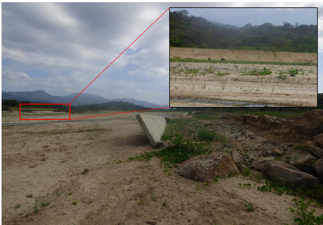
Figura 33. Quebrada Casitas – Bocapán. Hacia la margen derecha se observa barreras ribereñas afectadas. En la margen izquierda la protección es con arrimado de material.
