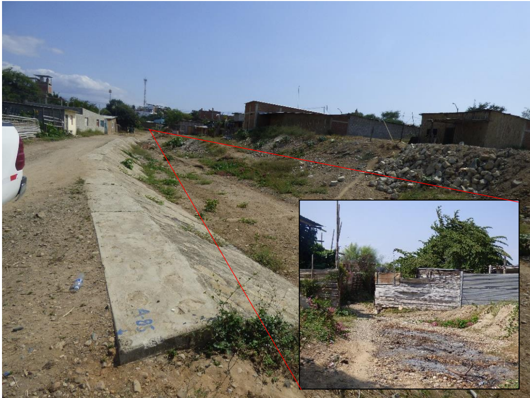
Figura 27. Quebrada en el pasaje Ramón Castilla (C.P. San Jacinto) canalizada parcialmente. Aguas abajo, se presenta viviendas dentro del cauce.
