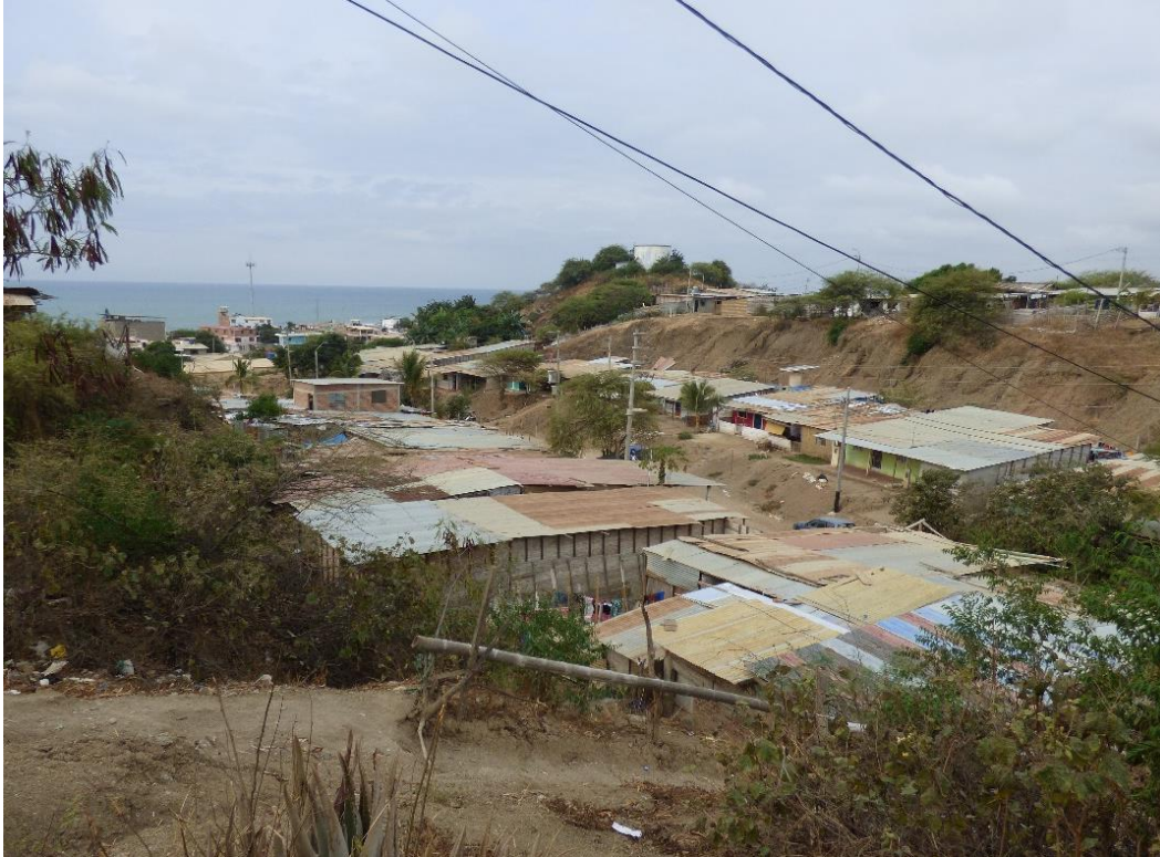
Fotografía 19. Sector Las Palmeras, distrito de La Cruz. Se aprecian viviendas situadas en el pie del talud donde se generan derrumbes. Se observa sustrato poco competente, pendiente muy fuerte. Coordenadas UTM: 545183 / 9597786, Zona 17. Tomado el 22/08/2023.
