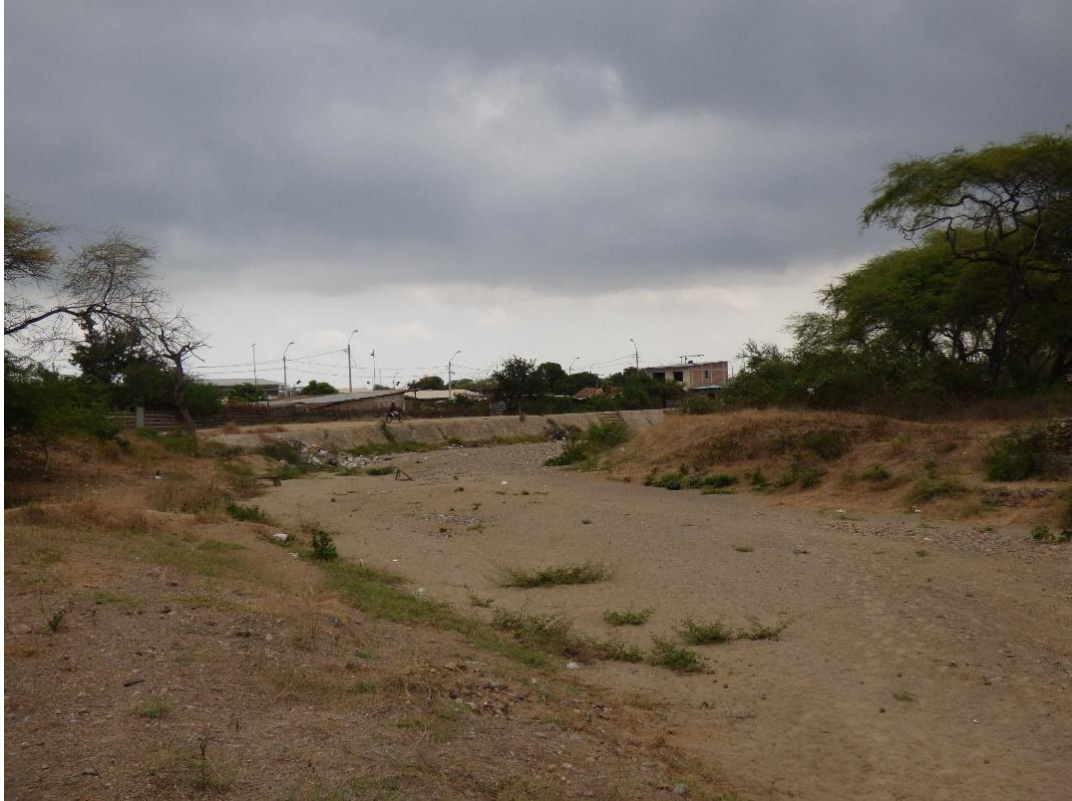
Fotografía 12. Quebrada Cristal (vista aguas abajo), Corrales. Presenta defensas ribereñas, en ciertos tramos, con muros y gaviones.
