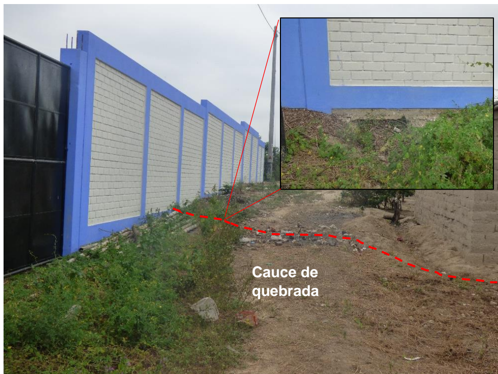
Figura 22. Cauce de quebrada atravesando colegio I.E. Capitán FAP, centro poblado José Abelardo Quiñones, distrito de Papayal.
