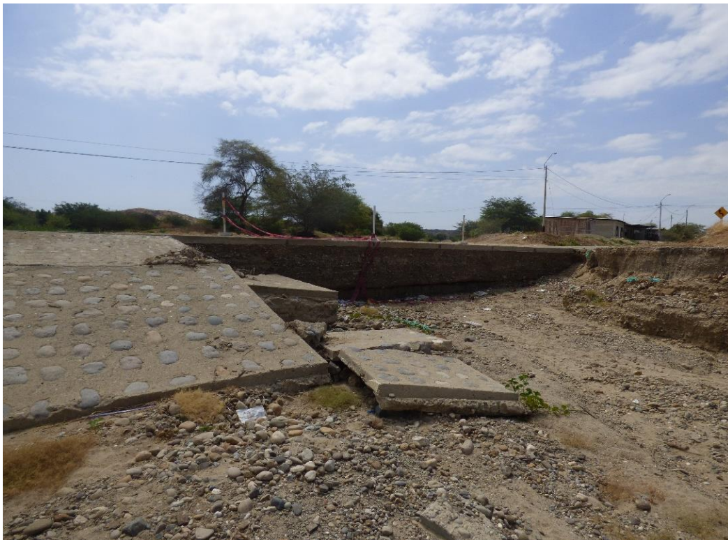
Fotografía 15. Colapso de protección de vía Corrales – San Jacinto por activación de quebrada La Peña, San Jacinto, durante el evento del ciclón Yaku 2023.
