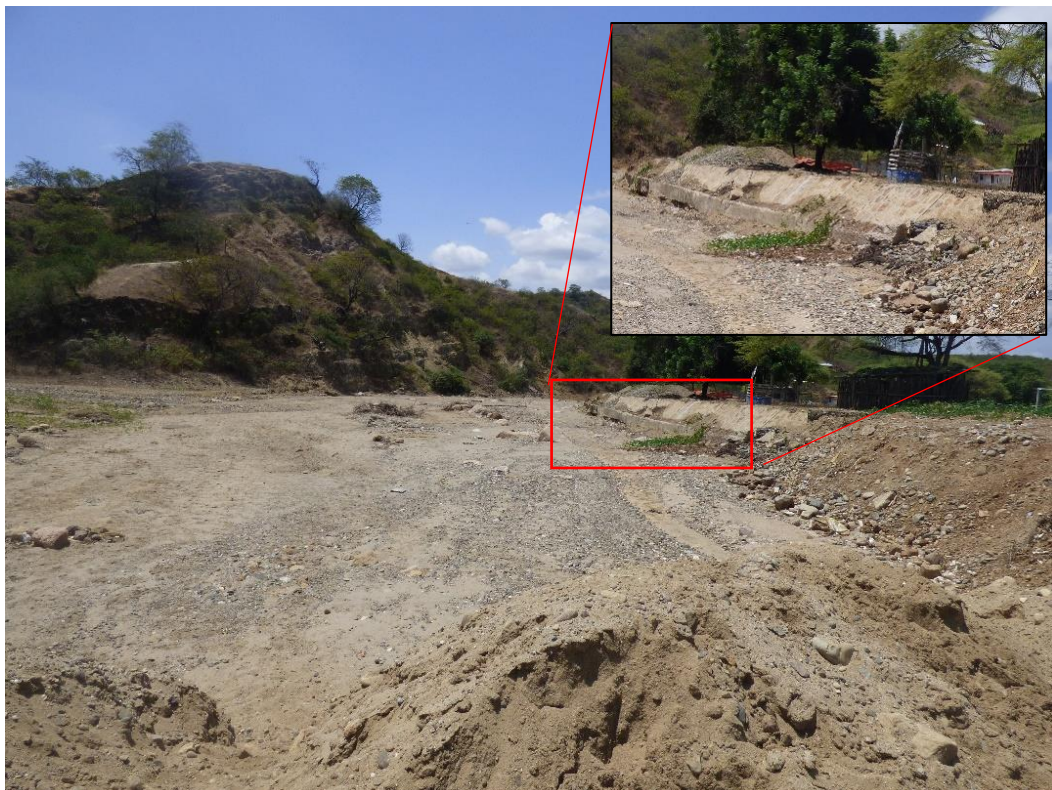
Figura 28. Defensas ribereñas dañadas por flujo de detritos en el acceso al centro poblado La Capitana, San Jacinto.
