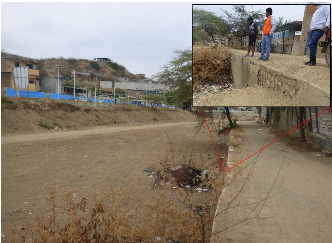
Figura 31. Vista aguas debajo de la quebrada Los Pozos, distrito de Zorritos, con defensas ribereñas desgastadas (margen derecha) y cubiertas por desmonte o viviendas (margen izquierda).
