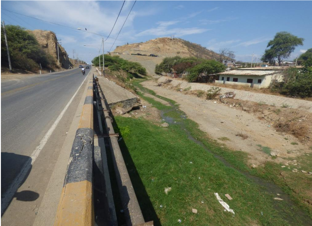
Fotografía 21. Cruce de la quebrada Tucillal con la vía Panamericana Norte. Se observa bases con erosión retrogresiva en los muros laterales hacia la vía. Coordenadas UTM: 558272 / 9599441, Zona 17. Tomado el 25/08/2023.
