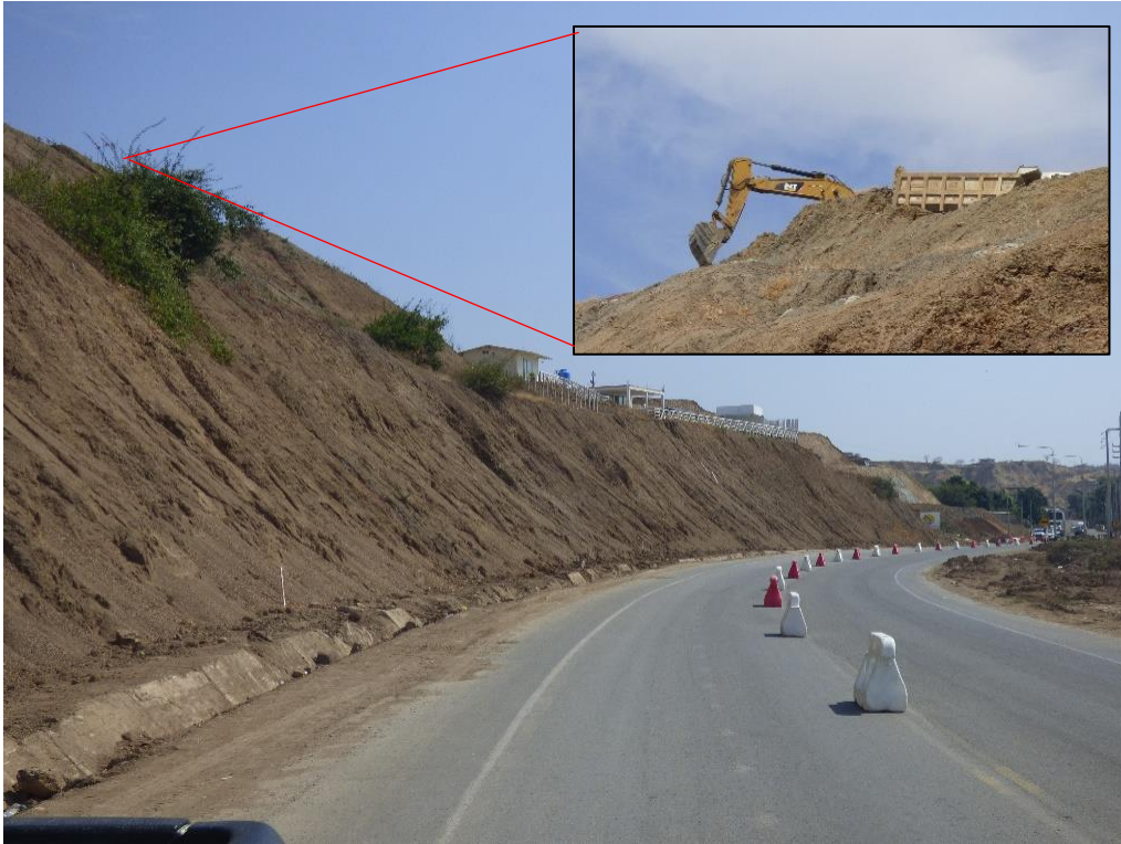
Figura 29. Sector Malpaso, recurrente en derrumbes en un tramo de 2 km de la vía Panamericana Norte. Actualmente presenta trabajos de banqueteo o perfil de talud. Coordenadas UTM: 541495 / 9595120, Zona 17. Tomado el 25/08/2023.
