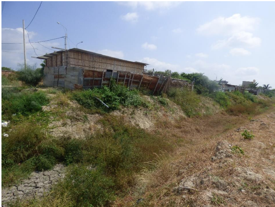
Fotografía 5. Viviendas al margen de la quebrada Quintiliano, que se encuentra colmatada y con procesos de erosión de ladera en la ribera. Sector Las Flores, Zarumilla.
