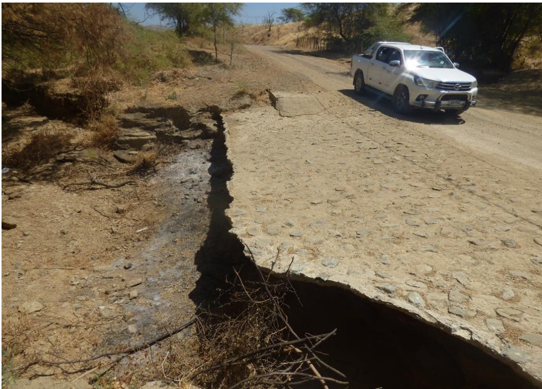
Fotografía 30. Baden con erosión retrogresiva hacia sus bases en la vía Máncora – Fernandez – Casitas, C.P. Barrancos, distrito de Canoas de Punta Sal.
