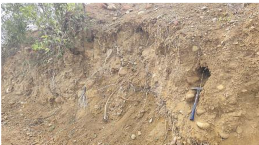
Fotografía 3. Suelos coluvio deluviales recientes, con bloques y cantos sub redondeados en una matriz de arcillas y limos de alta plasticidad.
