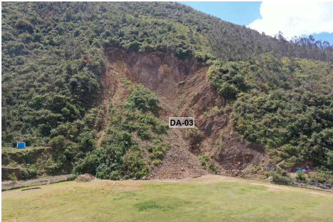
Figura 15. Vista del deslizamiento DA-03, claramente diferenciado por la remoción del material deslizado al pie de la ladera y afectando parte del campo deportivo de Cochabamba.
