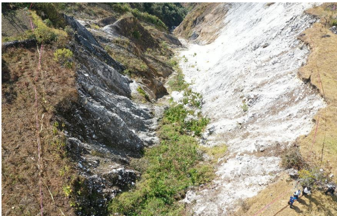
Fotografía 5. Vista de la erosión en cárcava activa EC-01 , con derrumbes en ambas márgenes, generando el avance retrogresivo y el ensanchamiento de estas en 110 m en la zona más amplia.
