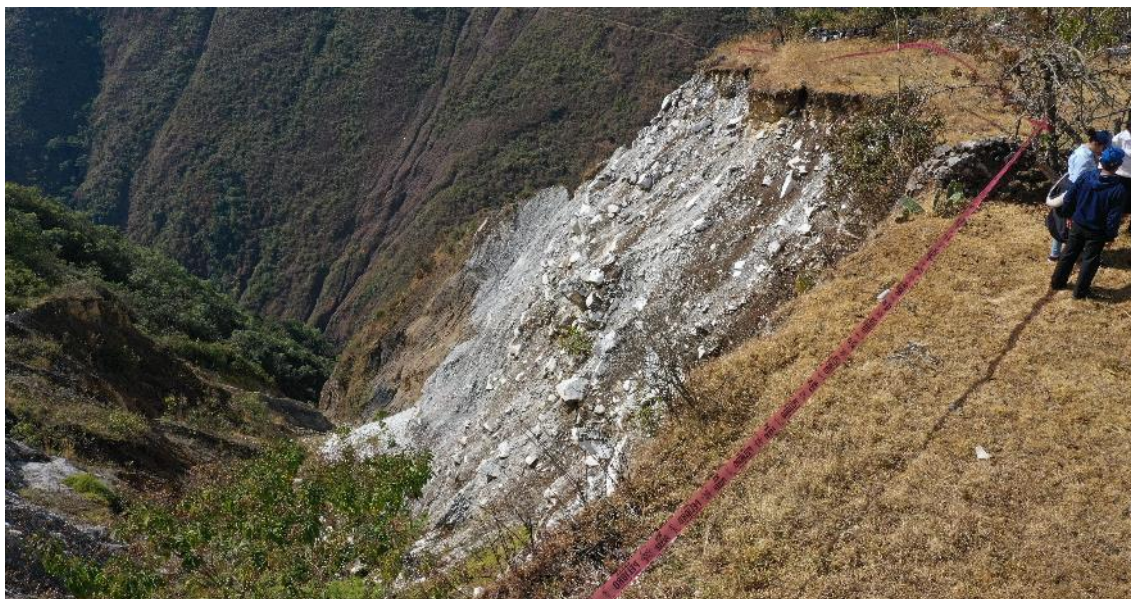
Fotografía 6. Se muestra mayor erosión en la margen derecha de la cárcava. Actualmente la zona se muestra demarcada prohibiendo el paso peatonal.
