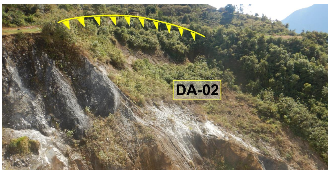
Figura 17. Deslizamiento activo (DA-02), producto del avance retrogresivo de la erosión en cárcava (EC-01) y que pone en peligro a viviendas ubicadas cerca de la escarpa principal.
