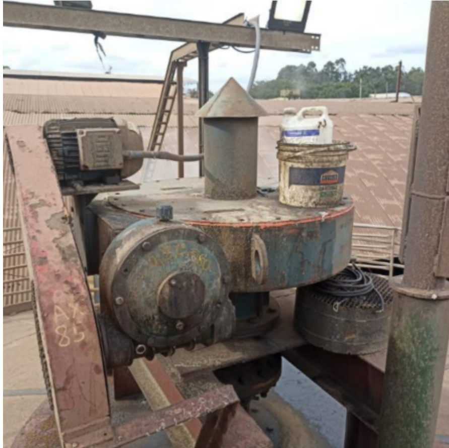
Figura 22 – Mexedor do Decantador 01 (Motor A).
