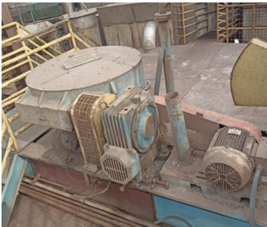
Figura 23 – Mexedor do Decantador 03 (Motor B).
