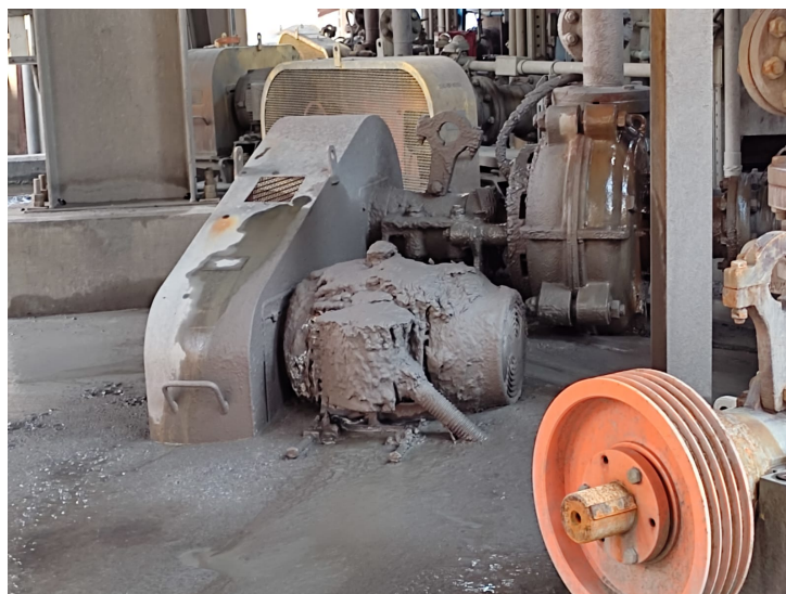
Figura 8 – Motor operando em uma planta de mineração.
