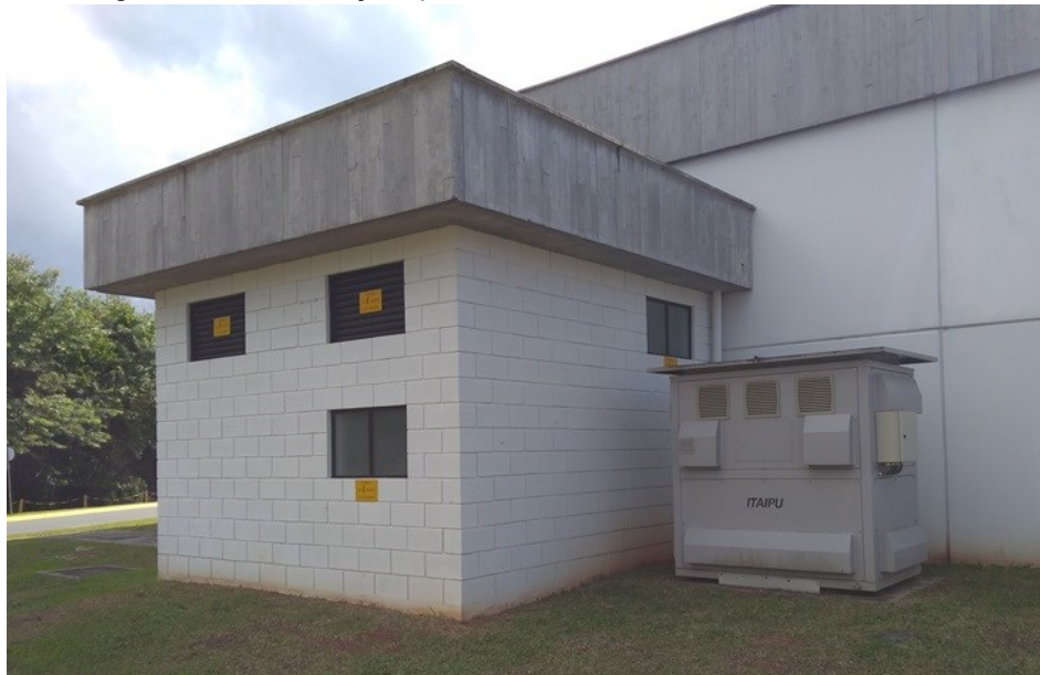
Figura 16 – Subestação que alimenta o Laboratório Túnel de Vento
