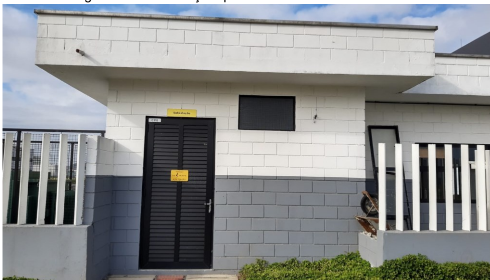
Figura 15 – Subestação que alimenta o Bloco Universitário.
