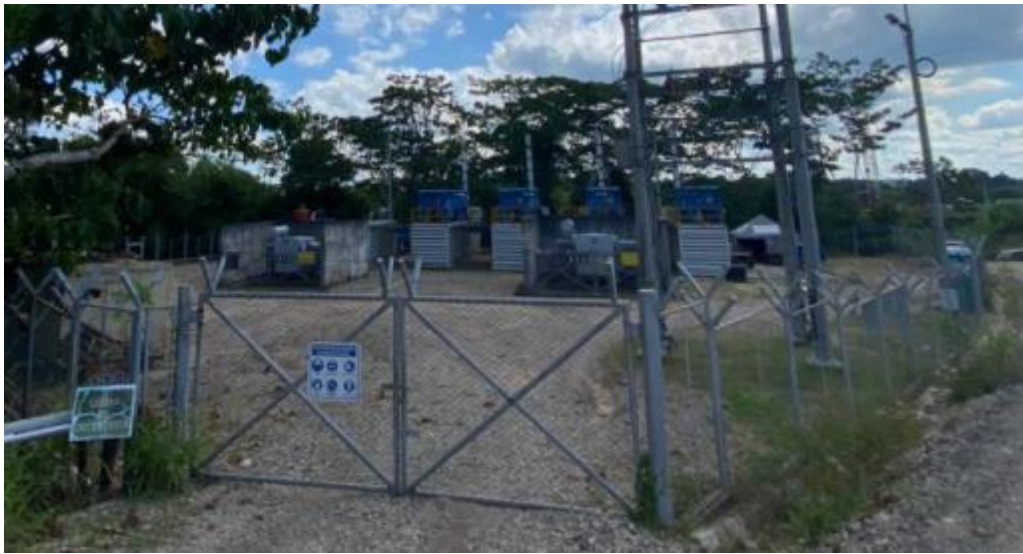
Figura 11. Centro de generación de energía Casabe Sur.
