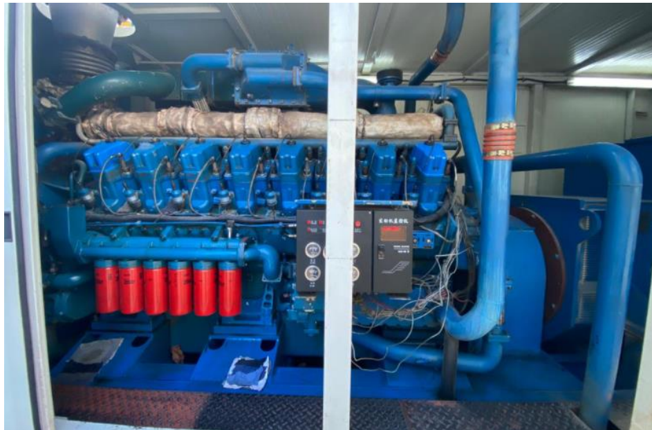
Figura 8. Generador de 1,2 MW Campo Casabe.
