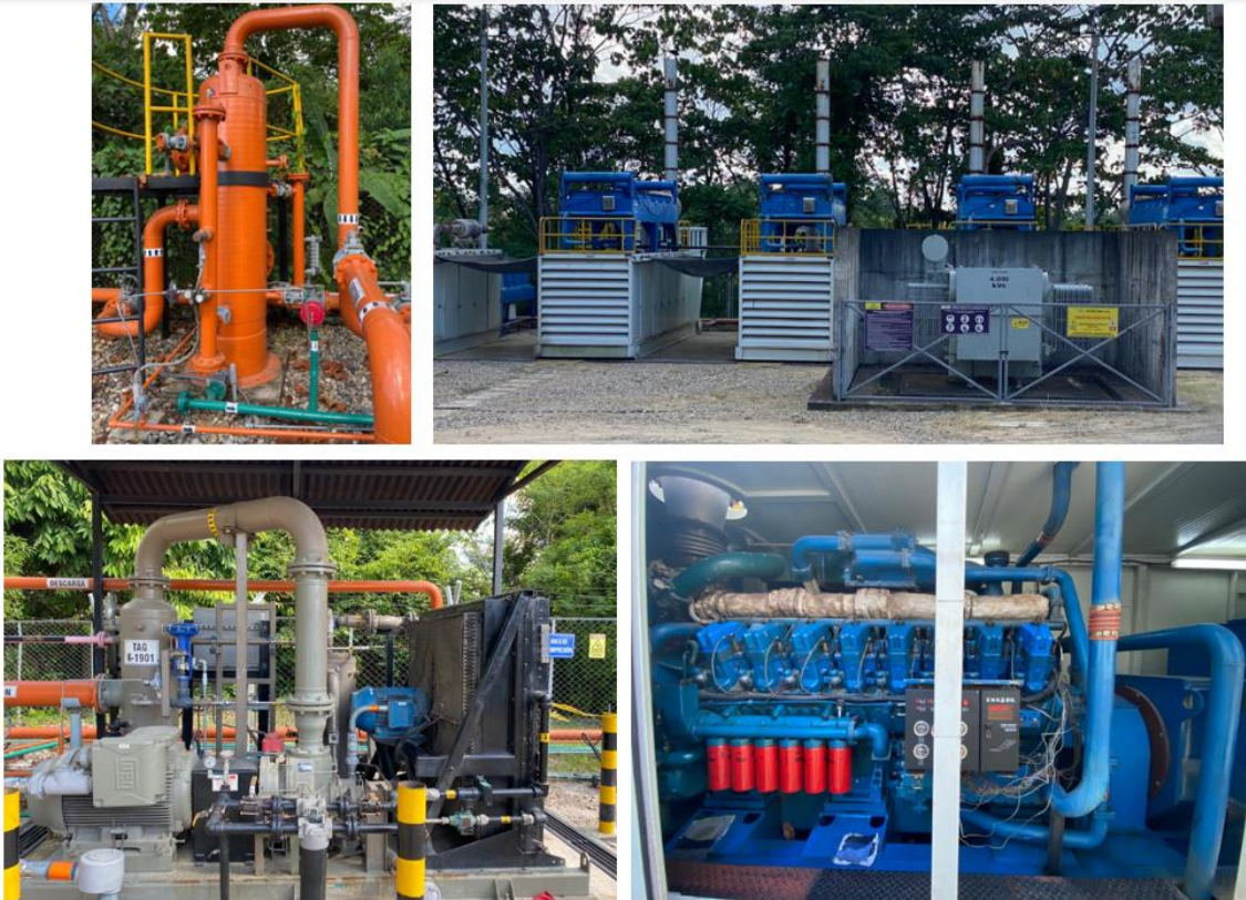
Figura 22. Equipos utilizados en el Centro de generación.
