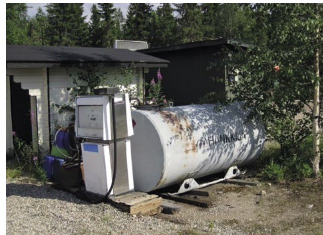
Polttoainesäiliö ja tankkauspaikka on sijoitettava kantavalle täyden säiliön painon kestäväälle alustalle. Säiliön ympärille on jätettävä riittävät suojaetäisyydet rakennuksiin, ojiin ja vesistöihin. KUVA: OLLI HIRSIMÄKI
