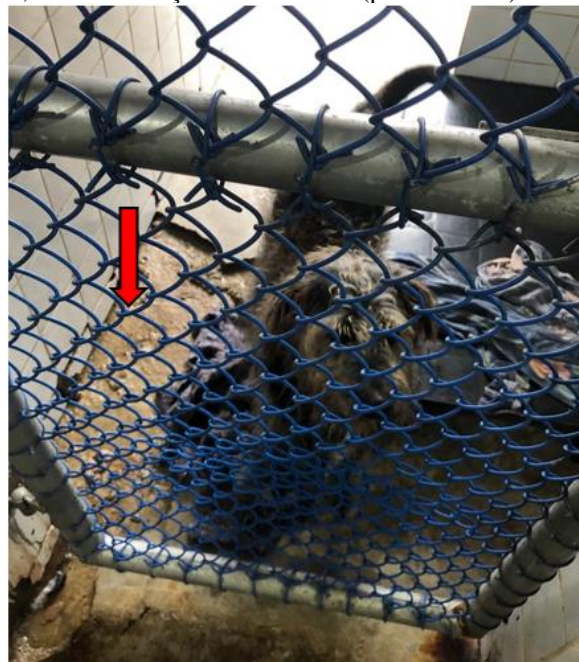
Figura 3 Baia com um cão, estrado e lençol. Evidencia-se (ponta da seta) revestimento do piso quebrado.
