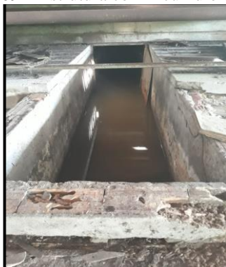
Figura 09 – Estrutura com Acúmulo de Água
