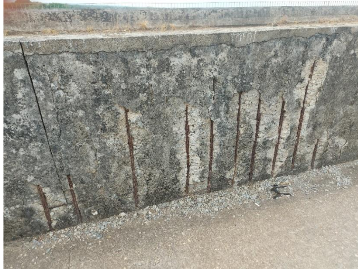
Figura 6 – Processo de desagregação do concreto na Ponte Dom Affonso Felipe Gregory.
