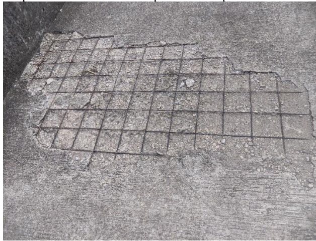
Figura 3 – Desgaste superficial identificado na passarela da ponte Dom Affonso Felipe Gregory.
