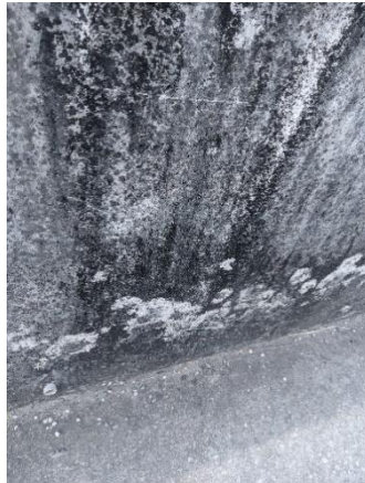
Figura 7 – Processo de eflorescência observado na Ponte Dom Felipe Gregory.
