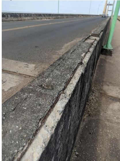
Figura 2 – Armaduras expostas nas defensas da Ponte Do Affonso Felipe Gregory.
