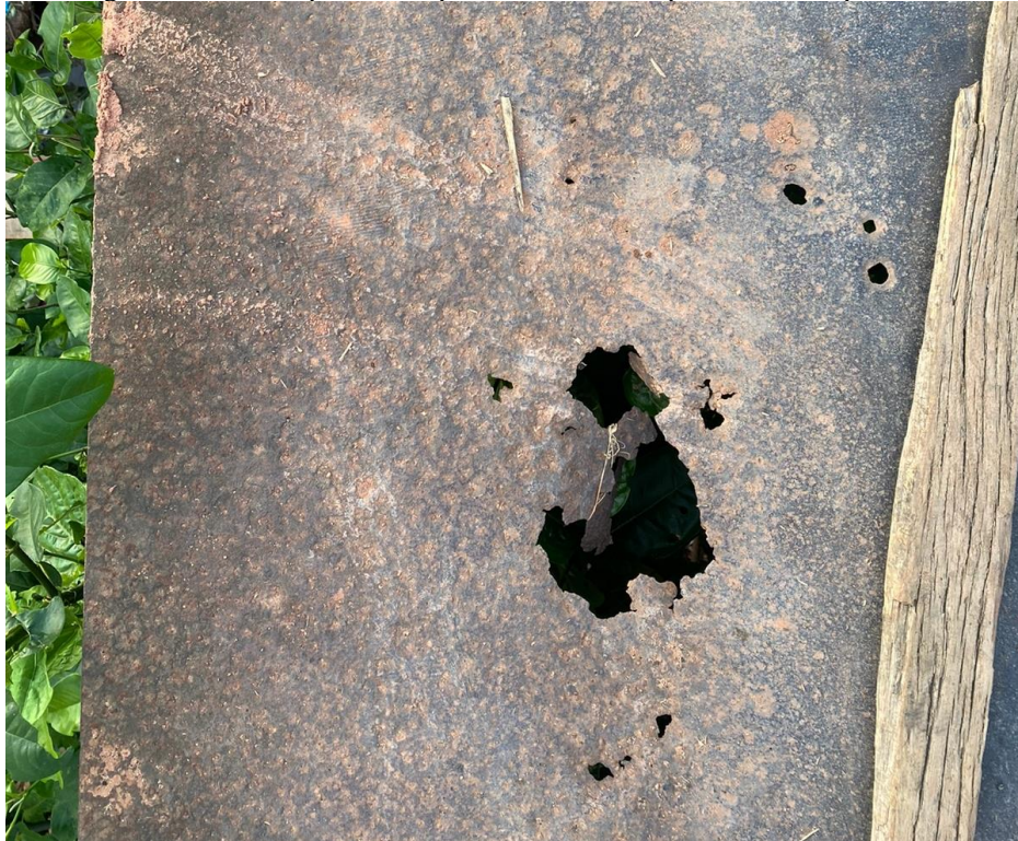
Figura 4 - Buraco provocado por corrosão na chapa metálica da passarela
