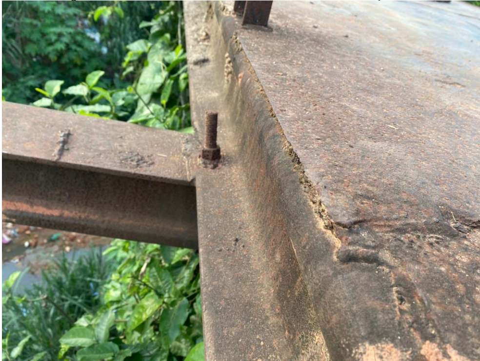
Figura 5 - Processo de corrosão nos elementos estruturais da passarela
