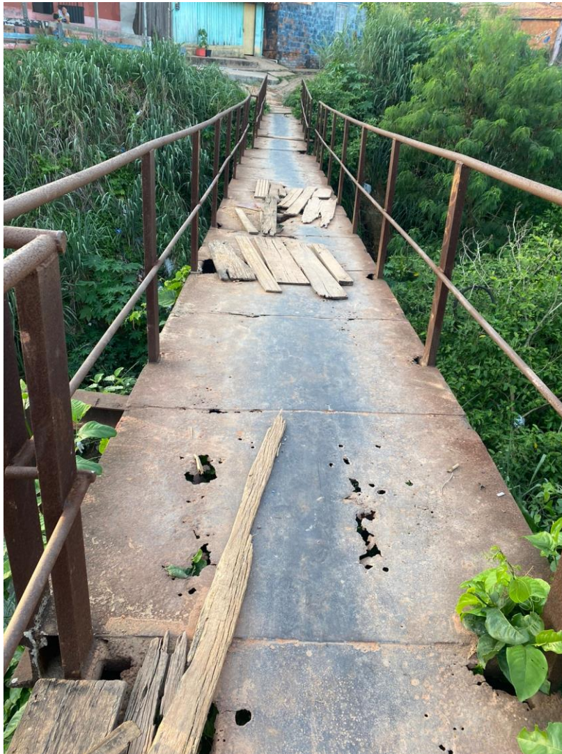
Figura 4 - Elementos afetados pela corrosão da estrutura da passarela e substituição do tabuleiro por tábuas de madeira
