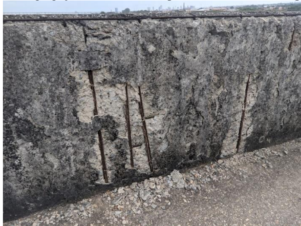
Imagem 5 - Desagregação do Concreto na ponte Dom Affonso Felipe Gregory.
