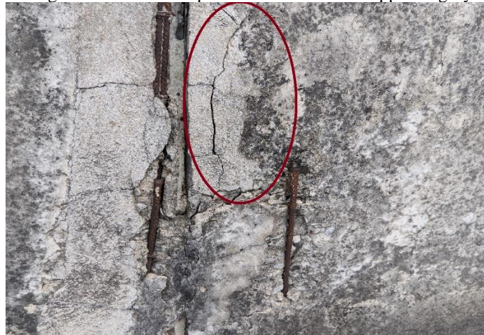
Imagem 6 - Fissuras na ponte Dom Affonso Felipe Gregory.
