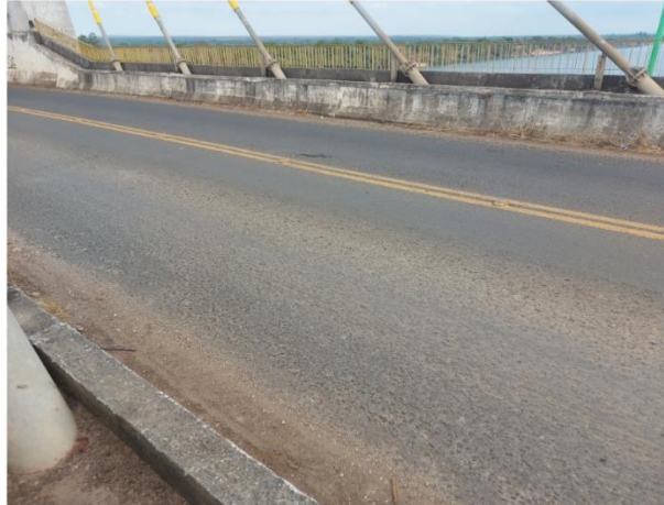
Imagem 2 – Exsudação de asfalto na ponte Dom Affonso Felipe Gregory.
