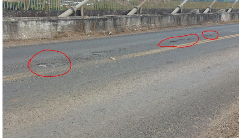
Imagem 3 – Buracos no asfalto da ponte Dom Affonso Felipe Gregory
