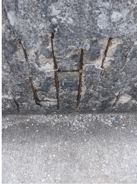
Imagem 9 - Corrosão das armaduras de aço na ponte Dom Affonso Felipe Gregory.
