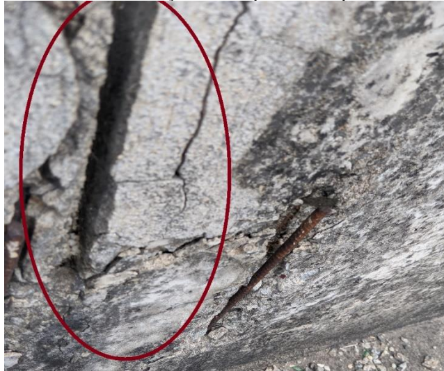
Imagem 8 - Rachaduras Proveniente da variação de Temperatura na ponte Dom Affonso Felipe Gregory.
