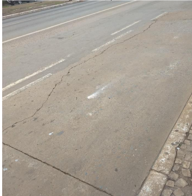
Figura 5. Exemplo de uma fissura longitudinal no pavimento. Fonte: Elaborada pelos autores.
