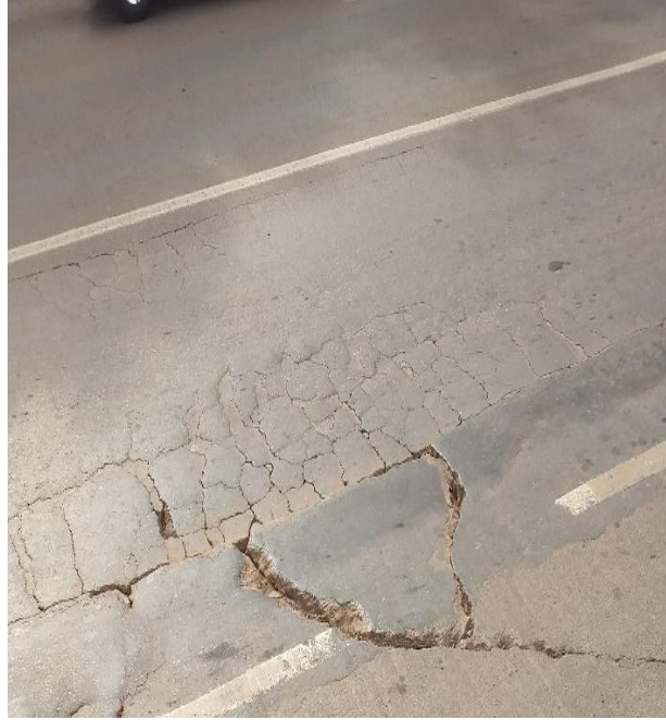
Figura 6. Exemplo de uma fissura em malha. Fonte: Elaborada pelos autores.
