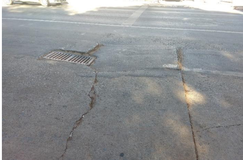
Figura 3. Exemplo de um afundamento no pavimento. Fonte: Elaborado pelos autores.
