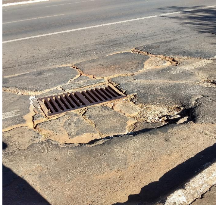
Figura 4. Exemplo de um buraco no pavimento. Fonte: Elaborada pelos autores.
