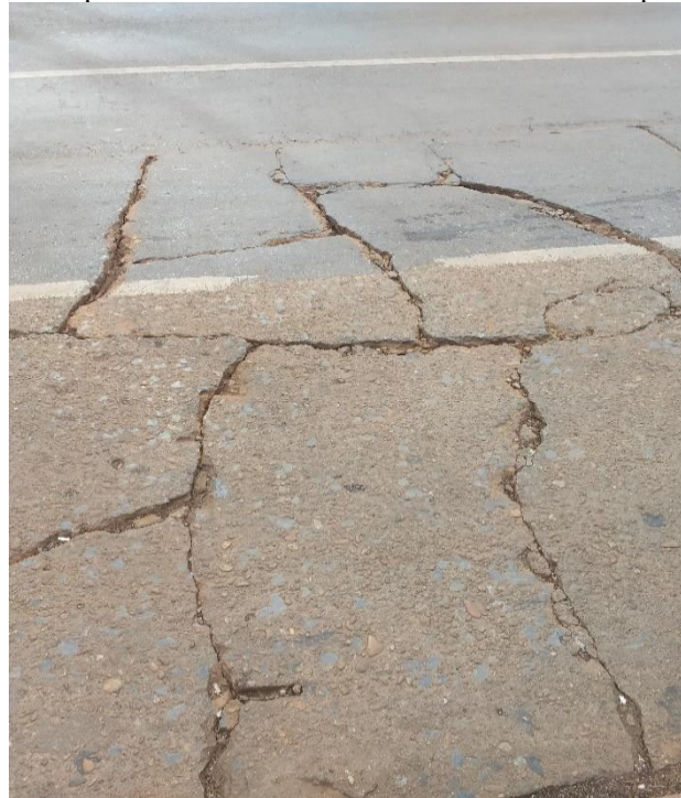
Figura 7. Exemplo de uma fissura em bloco. Fonte: Elaborada pelos autores.
