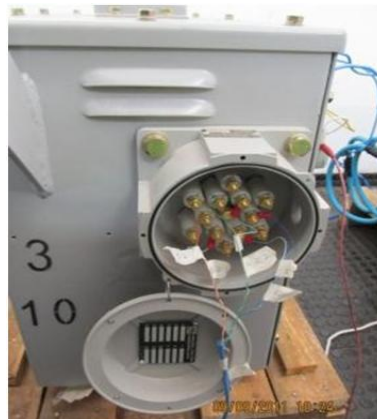
Fig. 3. Transformador construído com os sensores PT-100.
