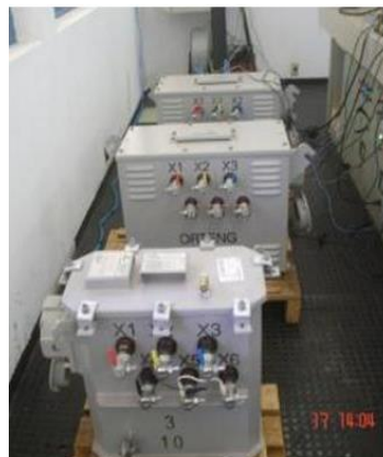
Fig. 2. Bancada e transformadores utilizados nos ensaios.
