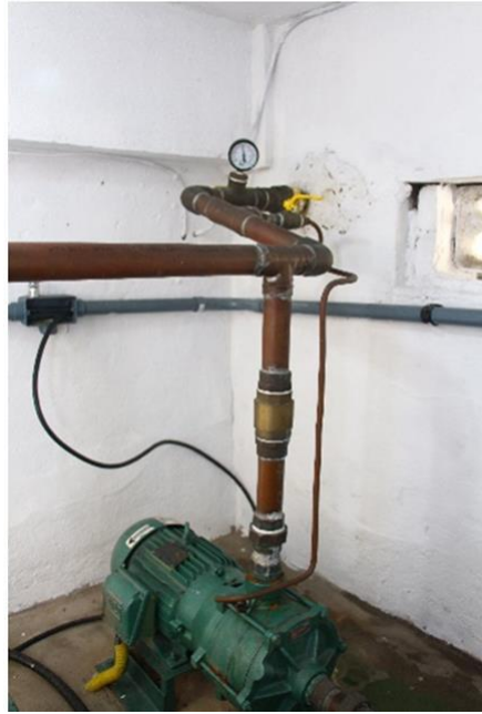
Figura 3 – Motobomba conectada nas caixas inferior e superior.
