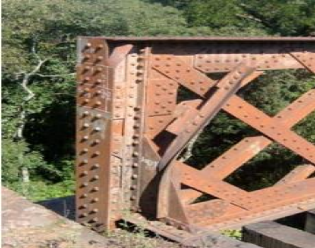
Figura 5: Deformações ocasionadas por choques de composições ferroviárias.
