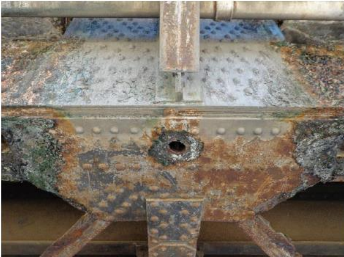
Figura 4: Corrosão generalizada com perda de seção ponte.
