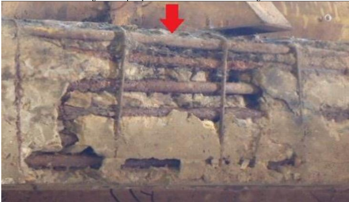
Figura 1: Exposição e corrosão das armaduras da viga.
