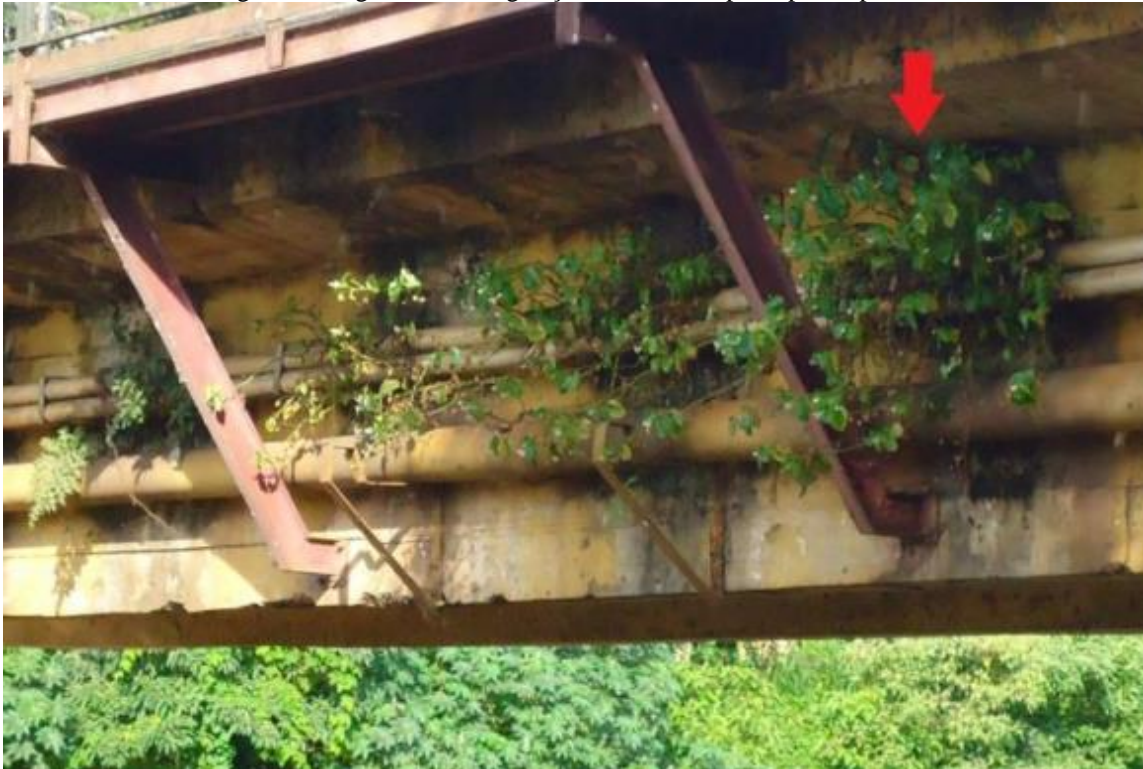
Figura 2: Surgimento de vegetação na estrutura principal da ponte.
