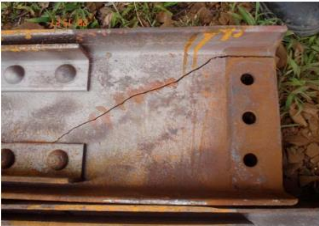
Figura 6: Trinca ocasionada por fadiga em uma das longarinas
