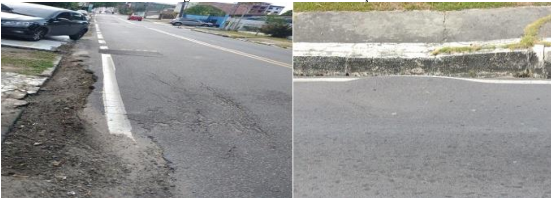
Figura 4- Afundamento da consolidação
