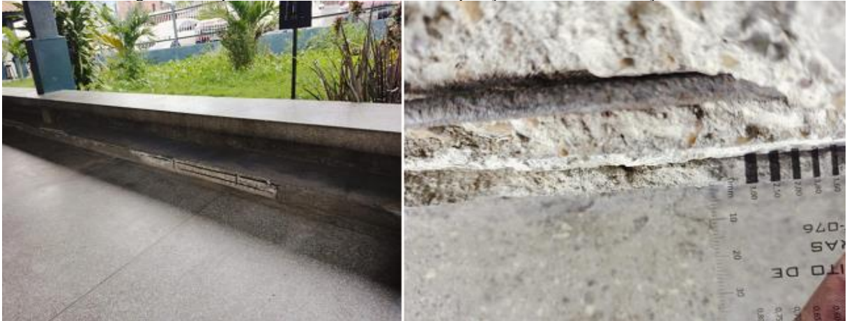
Figura 2: Deslocamento do Cobrimento e exposição da armadura de aço.
