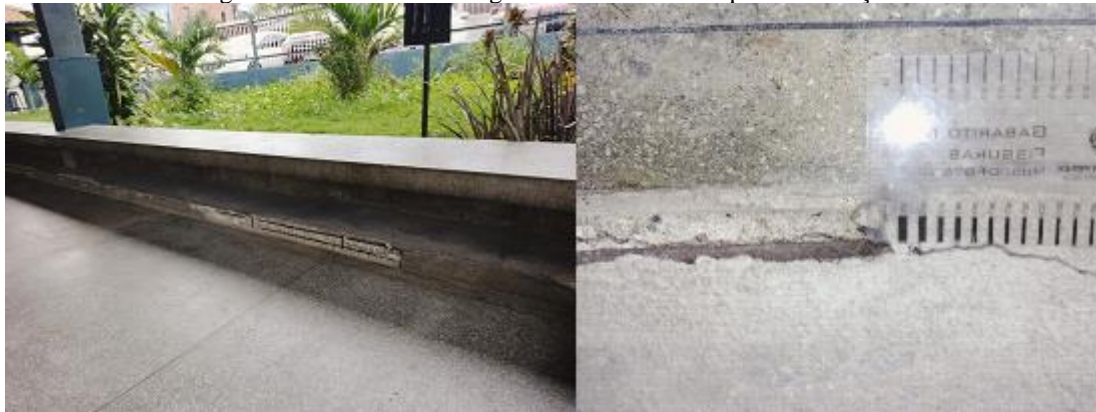
Figura 3: Observamos na figura abaixo um Recalque de fundação.
