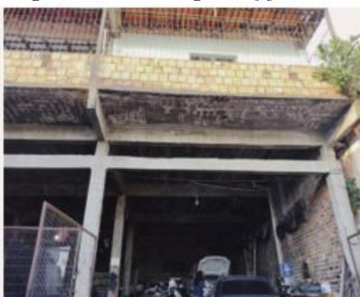
Figura 2- Estado Patológico da çaje Ed. 01
