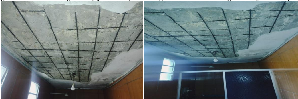
Figura 3- Estado Patológico da çaje Edificação 02 Figura 4-- Estado Patológico da laje Edificação 02
