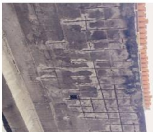
Figura 1- Estado Patológico da çaje Ed. 01
