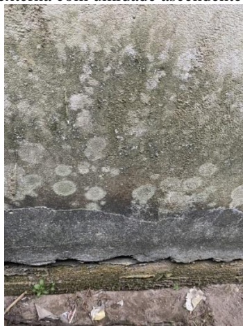
Figura 12: Parede externa com umidade ascendente e presença de mofo
