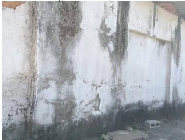
Figura 7: Parede com mofo
