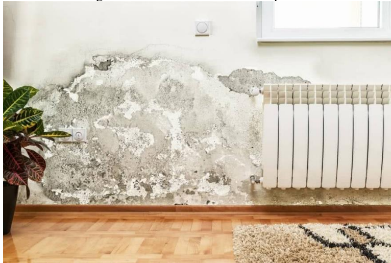
Figura 6: Umidade ascendente em parede.
