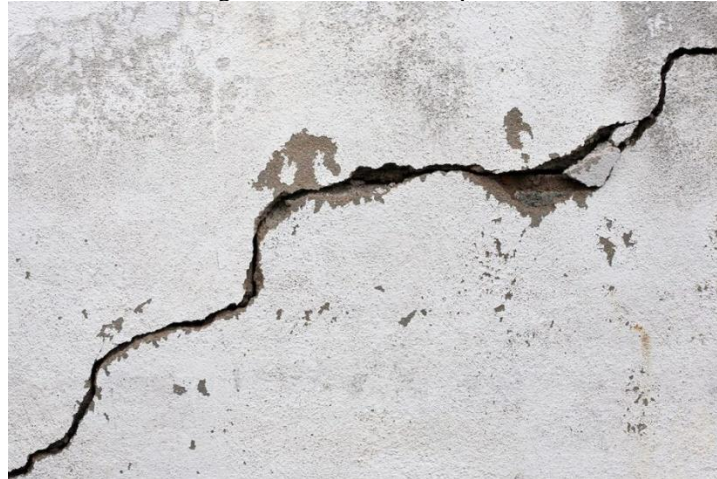
Figura 5: Rachadura em parede.
