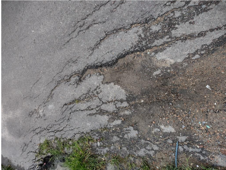
Figura 4 – Trincas Transversais Curtas
