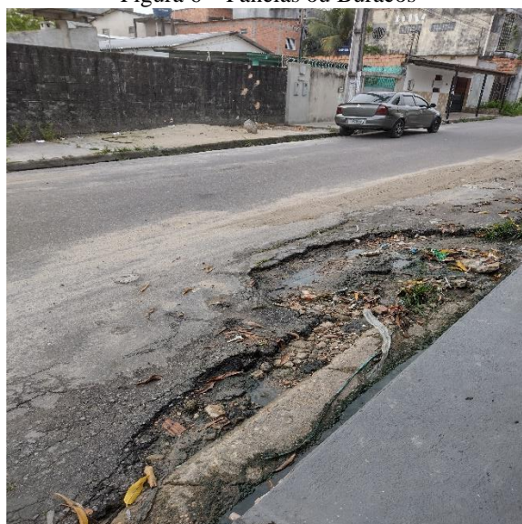
Figura 6 – Panelas ou Buracos
