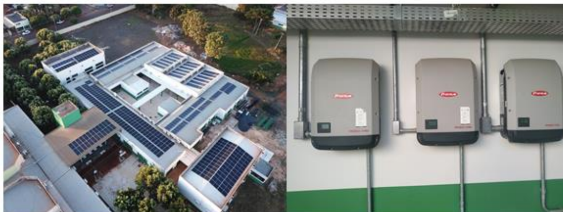
Figura 4 – Sistema solar instalado no campus.
