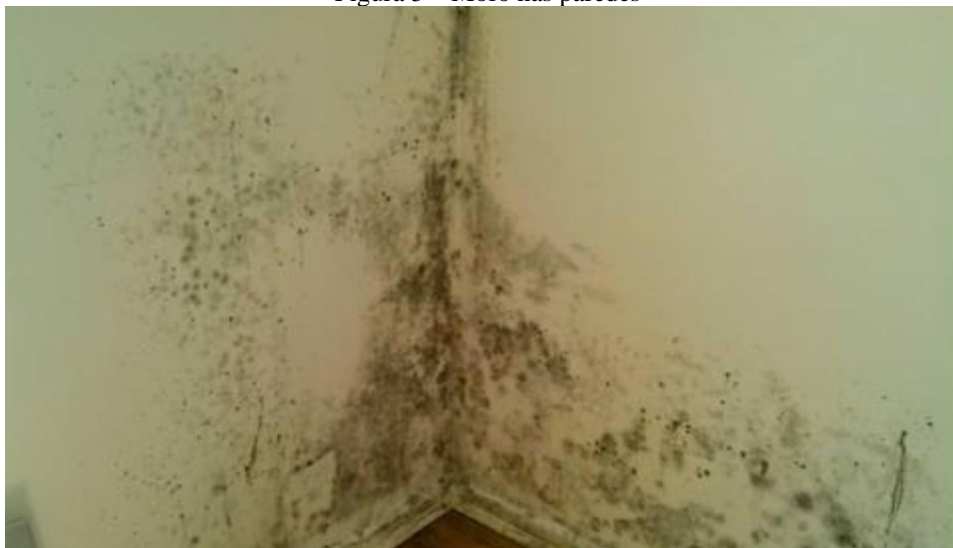
Figura 5 – Mofo nas paredes
