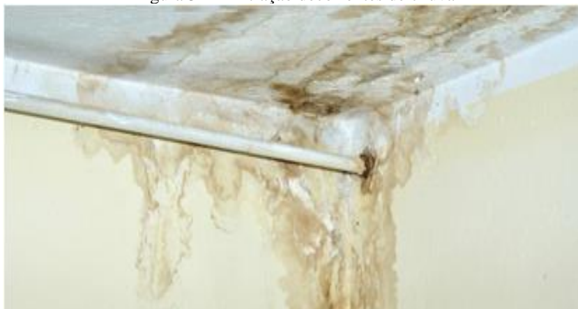
Figura 3 – Infiltração decorrentes de chuva
