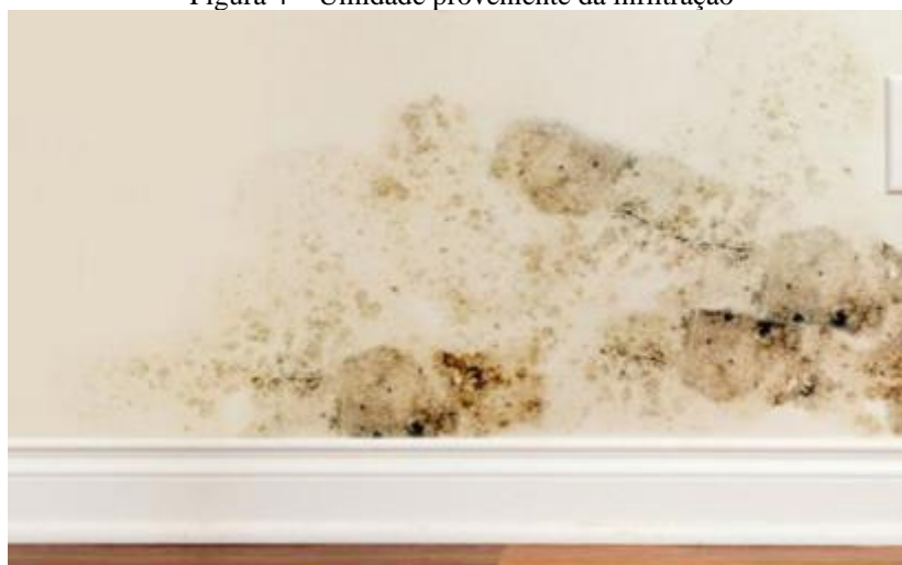
Figura 4 – Umidade proveniente da infiltração
