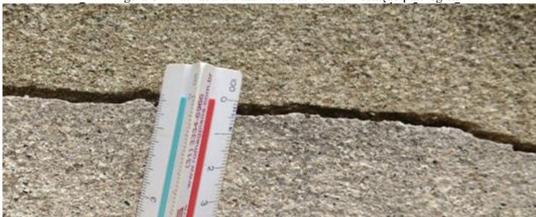
Figura 6 – Rachadura classificada como manifestação patológica
