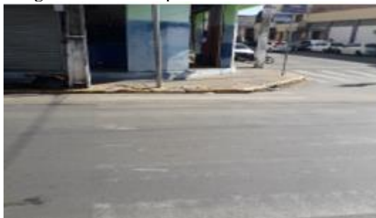
Figura 9 – Desgaste da faixa de pedestre na rua Almirante Alexandrino.
