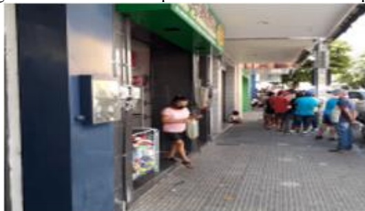
Figura 8 – Medidores expostos na rua Senador Pompeu.
