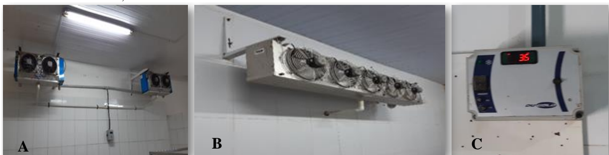
Figura 4 - Instalação elétrica (A), equipamento de refrigeração para manutenção da temperatura, variando de 10 a 16°C em todo ambiente de processamento (B) e controle de temperatura (C) em uma agroindústria de embutidos cárneos em Pelotas/RS, 2019/21.
