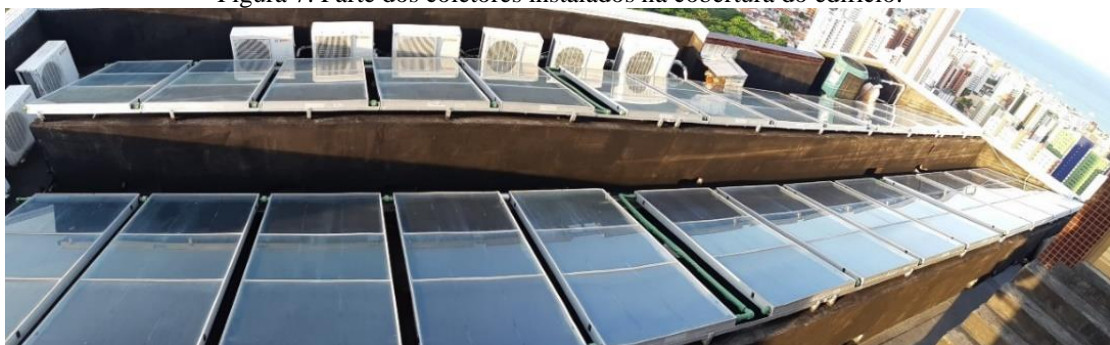
Figura 7. Parte dos coletores instalados na cobertura do edifício.
