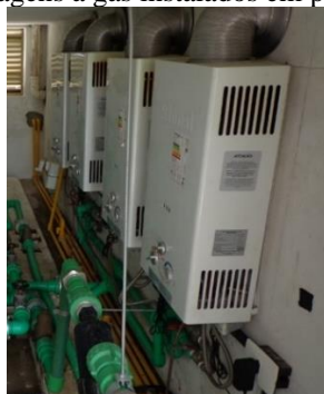
Figura 9. Aquecedores de passagens a gás instalados em paralelo na cobertura do edifício.
