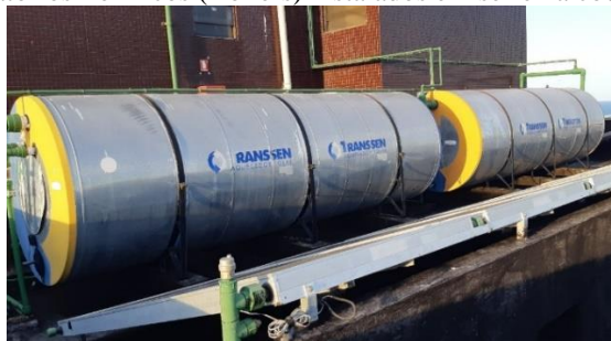
Figura 8. Reservatórios Térmicos (Boilers) instalados em série na cobertura do edifício.
