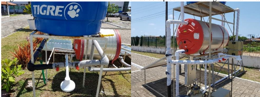
Figura 13- Isolamento Térmico nos Sistemas de aquecimento de água unifamiliar
