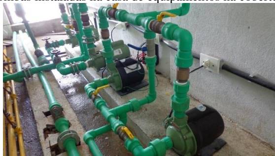
Figura 10. Bombas instaladas na casa de equipamentos na cobertura do edifício.
