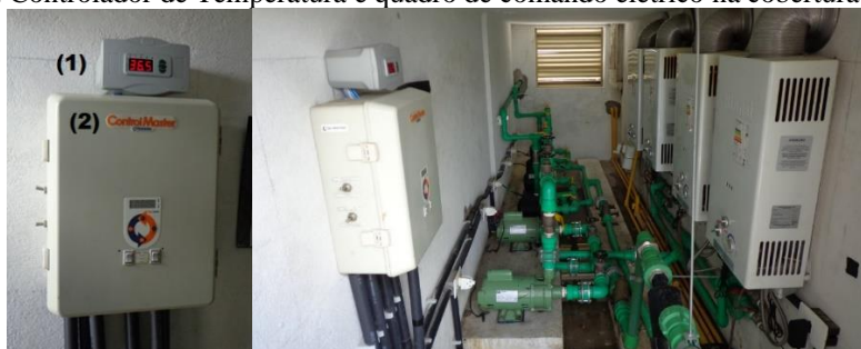
Figura 11. Controlador de Temperatura e quadro de comando elétrico na cobertura do edifício.
