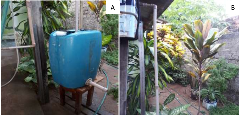
Figura 02: A- Reservatório da cisterna; B - Recipiente da Bomba volumétrica.
