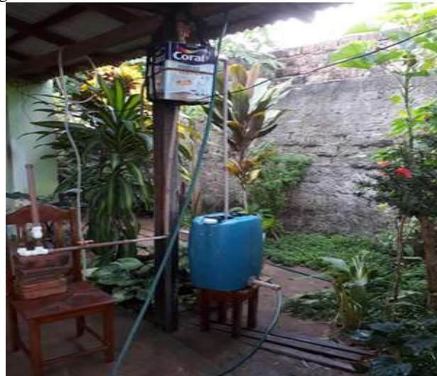
Figura 03: Cano na horizontal conectado ao carneiro hidráulico.
