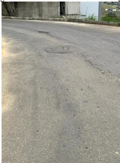
Figura 6: Afundamentos de consolidação.
