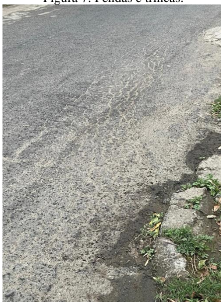
Figura 7: Fendas e trincas.
