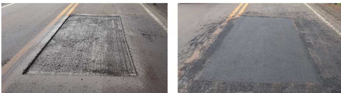
Figura 9: Remendo em rodovias.
