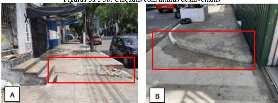
Figuras 3a e 3b: Calçadas com alturas desniveladas
