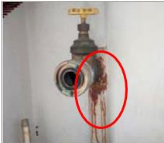
Figura 28: Válvula de hidrante com vazamento e oxidação
