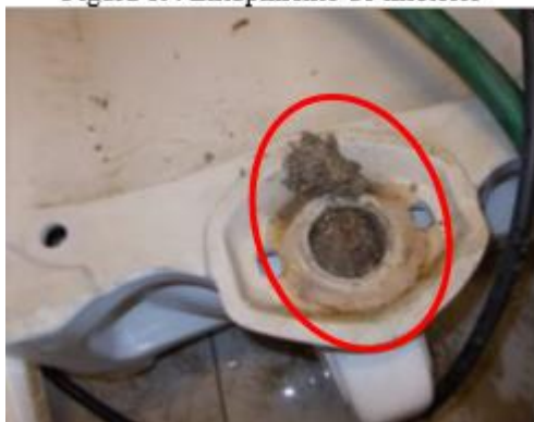
Figura 19: Entupimento do mictório
