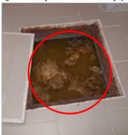
Figura 25: Entupimento de caixa de inspeção
