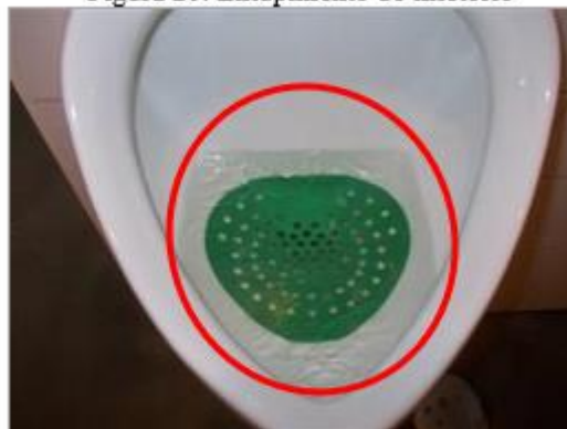
Figura 20: Entupimento do mictório
