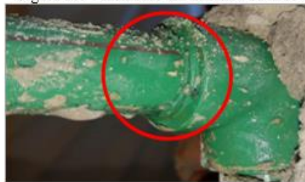
Figura 11: Vazamento em conexão de PPR
