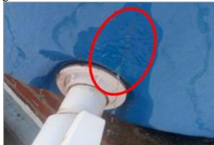
Figura 9: Rachadura em reservatório de fibra
