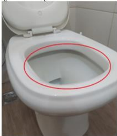
Figura 17: Entupimento da bacia sanitária
