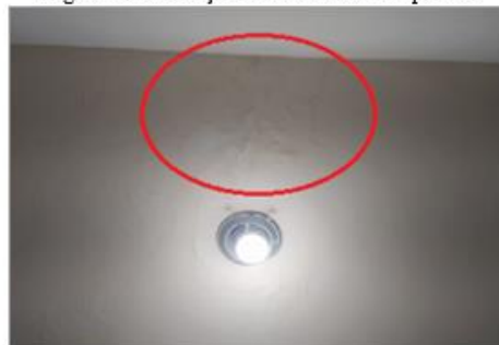
Figura 5: Infiltração com manchas na pintura
