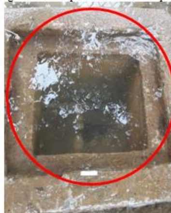
Figura 26: Entupimento de fossa séptica
