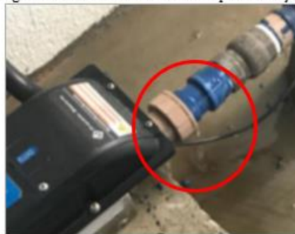
Figura 2: Vazamento na bomba de pressurização
