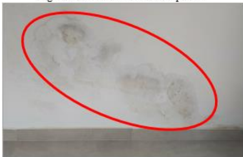
Figura 4: Manchas de mofo na parede
