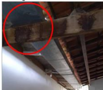
Figura 14: Vazamento da calha
