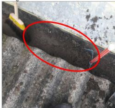
Figura 16: Acúmulo de material na calha
