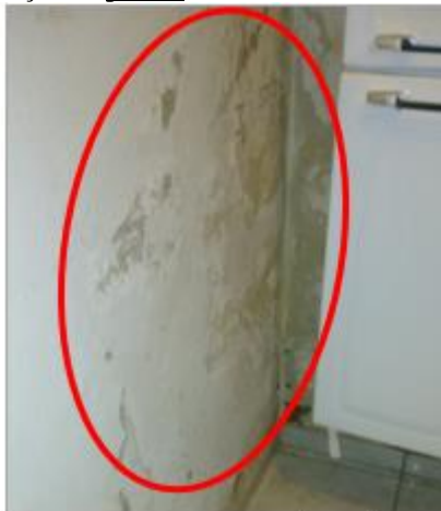
Figura 6: Infiltração na p arede de divisa da cozinha com a despensa
