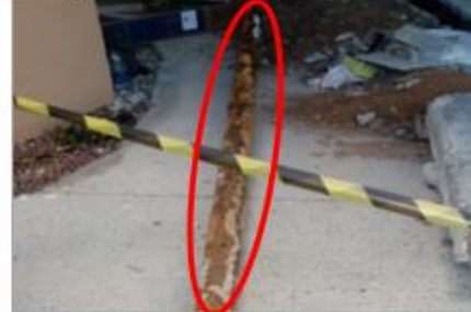
Figura 8: Tubulação exposta e corroída
