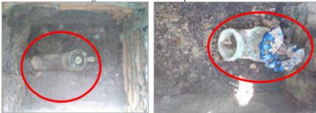
Figura 29: Hidrantes de recalque deteriorados
