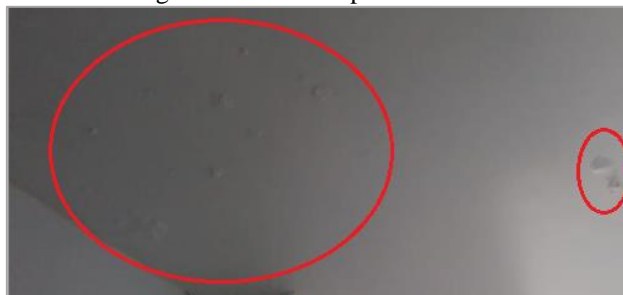
Figura 3: Bolhas na pintura do teto
