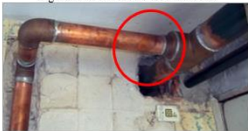
Figura 10: Corrosão no tubo de cobre
