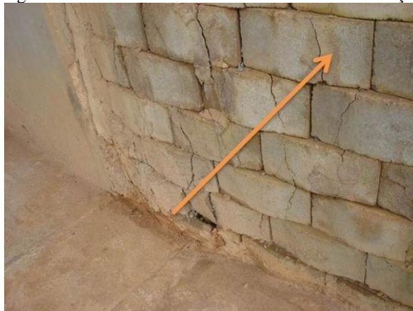
Figura 1: Trincas Devido à Instabilidade Muro-Fundação
