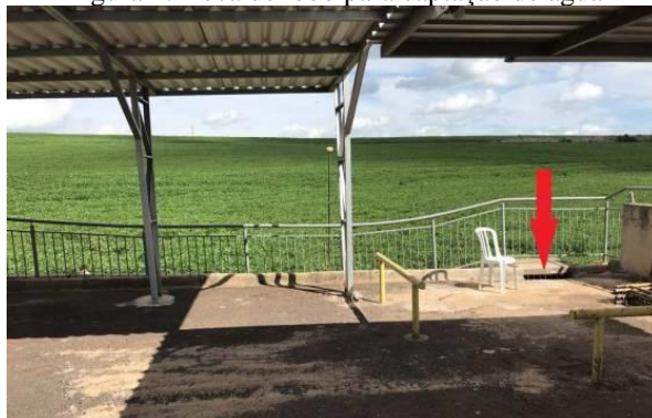
Figura 4: Boca de lobo para captação de água
