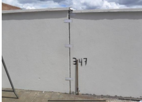
Figura 3: Deslocamento e trincas na contenção
