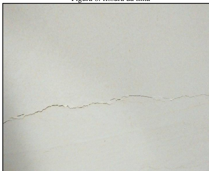
Figura 6: fissura da tinta
