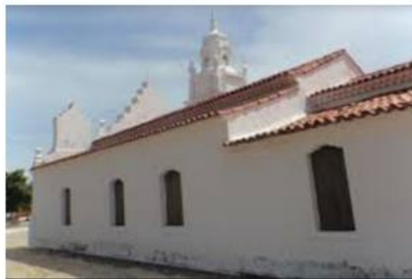
Figura 17 – Área com biodeterioração.
