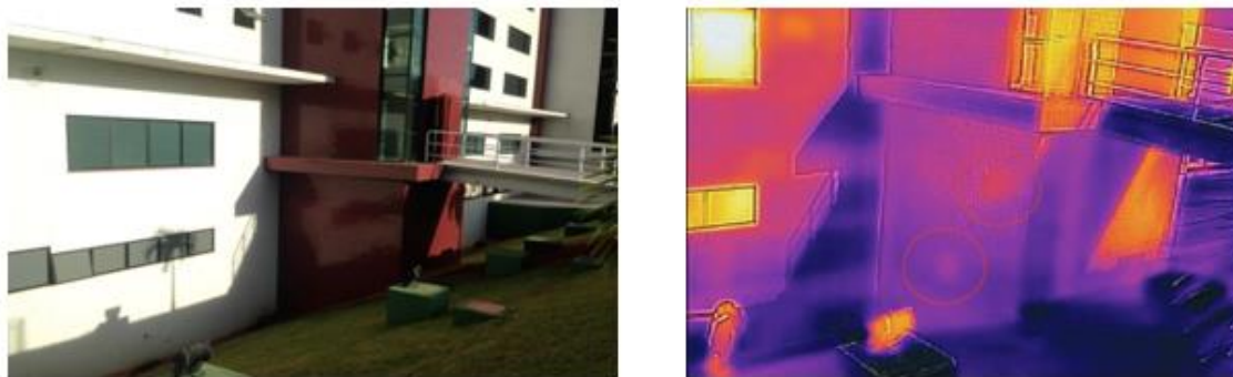
Figura 07 - Imagem termográfica evidenciando anomalias do revestimento cerâmico.
