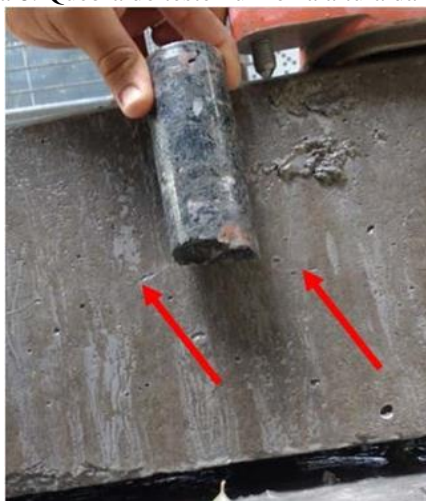
Figura 8: Quebra do testemunho na altura da fissura
