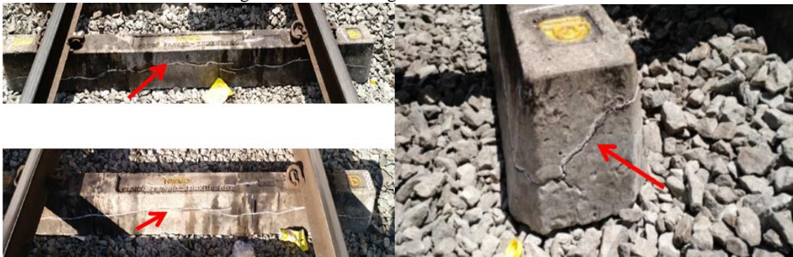
Figura 4: Fissuras longitudinais nos dormentes
