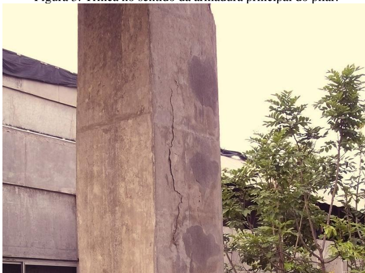
Figura 3: Trinca no sentido da armadura principal do pilar.
