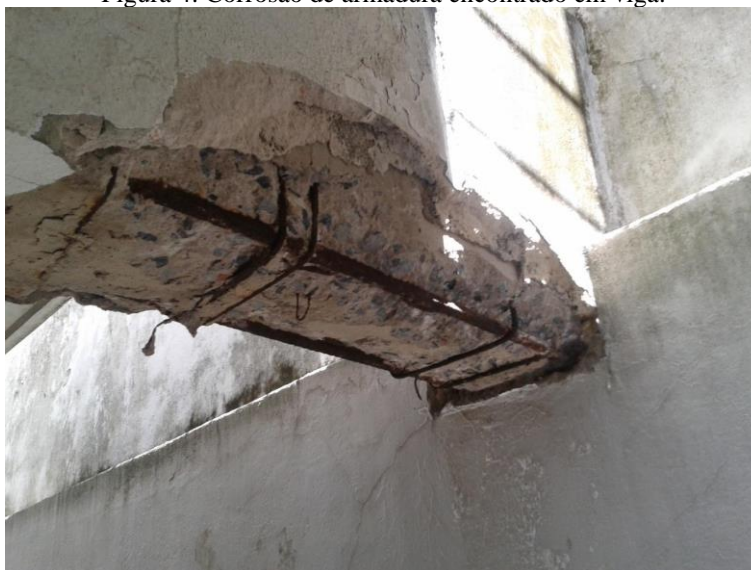
Figura 4: Corrosão de armadura encontrado em viga.
