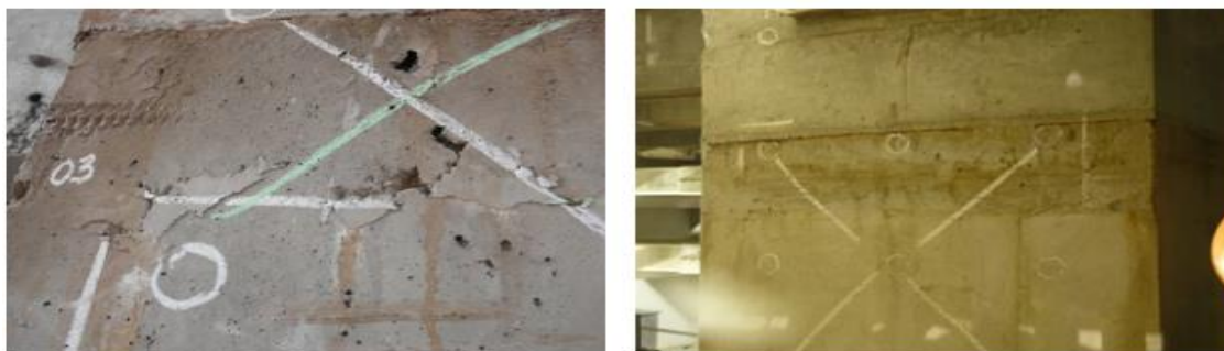
Figura 4: Detalhe da superfície do topo de algum dos pilares analisados
