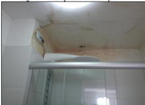
Figura 3 - Consequência da Infiltração.
