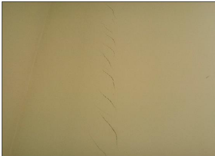
Figura 10 – Fissuras em direções aleatórias.
