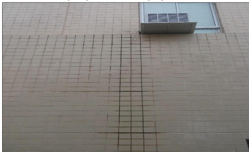
Figura 9 – Fachada desgasta pelo acumulo de agua proveniente do ar condicionado.
