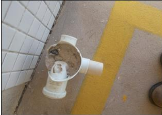
Figura 5 – Caixa sifonada obstruída.
