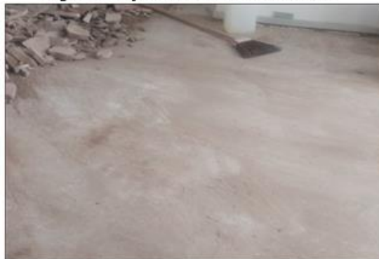
Figura 8 – Laje sem revestimento cerâmico.
