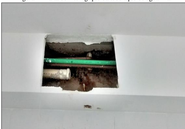
Figura 4 - Falta de interligação da tubulação de água fria.
