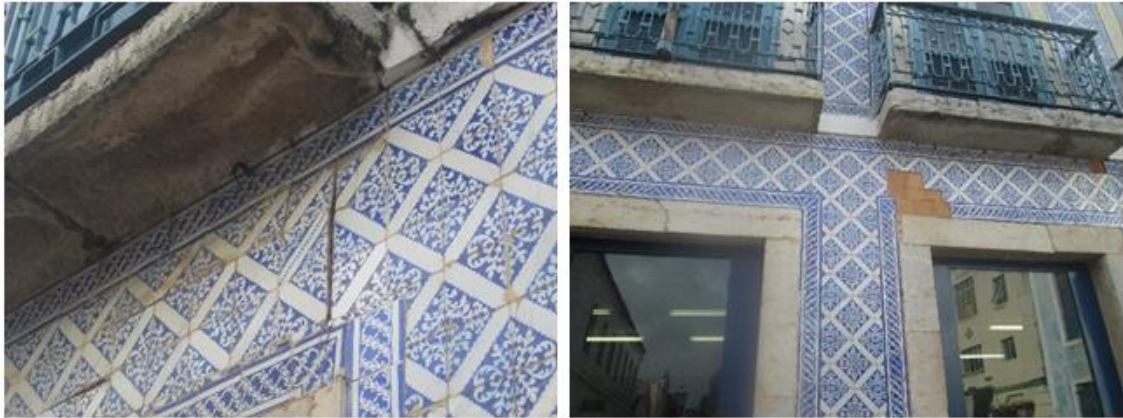
Figuras 5 e 6: Manifestações patológicas no revestimento em azulejo da fachada
