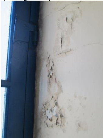
Figura 3: Manifestação patológica na parede em diversos pontos da edificação
