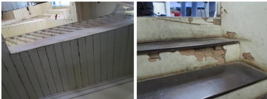
Figuras 11 e 12: Estrutura da escada de madeira deteriorada
