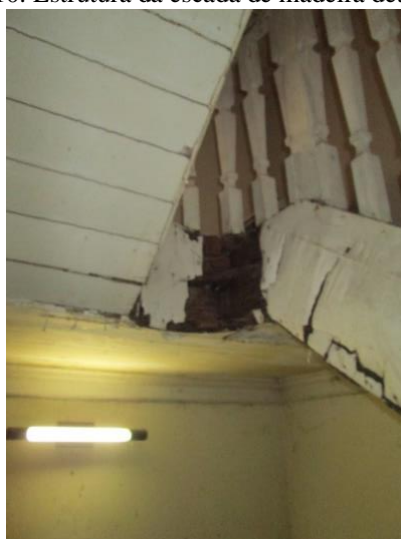
Figura 10: Estrutura da escada de madeira deteriorada.
