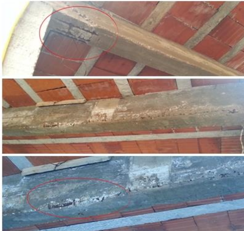
Figura 4: Outras vigas 35x14 com suas armaduras expostas e corroídas. Sem cobrimento adequado ocasionado por mal execução das fôrmas
