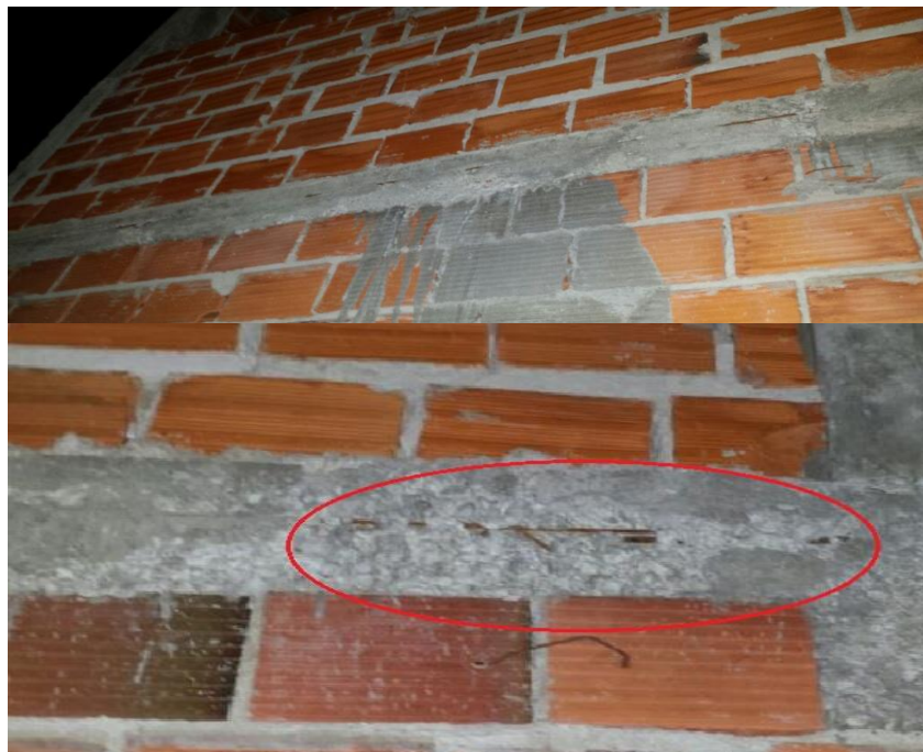
Figura 3: Viga 35x14 com suas armaduras expostas e corroídas por cloretos ocasionados por má execução da viga
