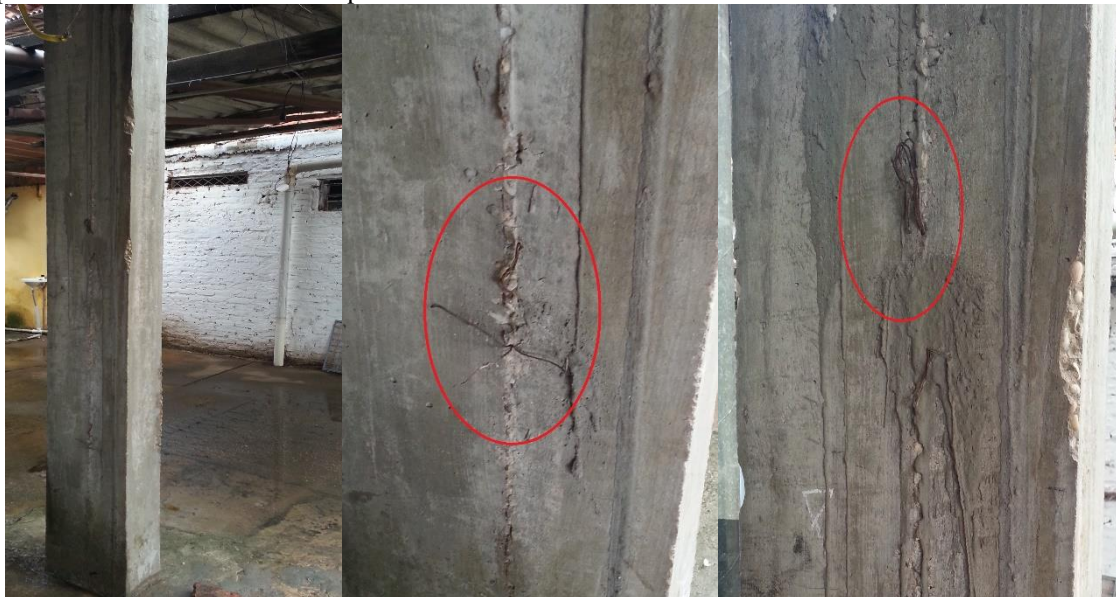
Figura 5: a) Pilar 40x15; b) e c) Arames evidenciados pela má execução das fôrmas podendo ocasionar problemas futuros com corrosão por cloretos
