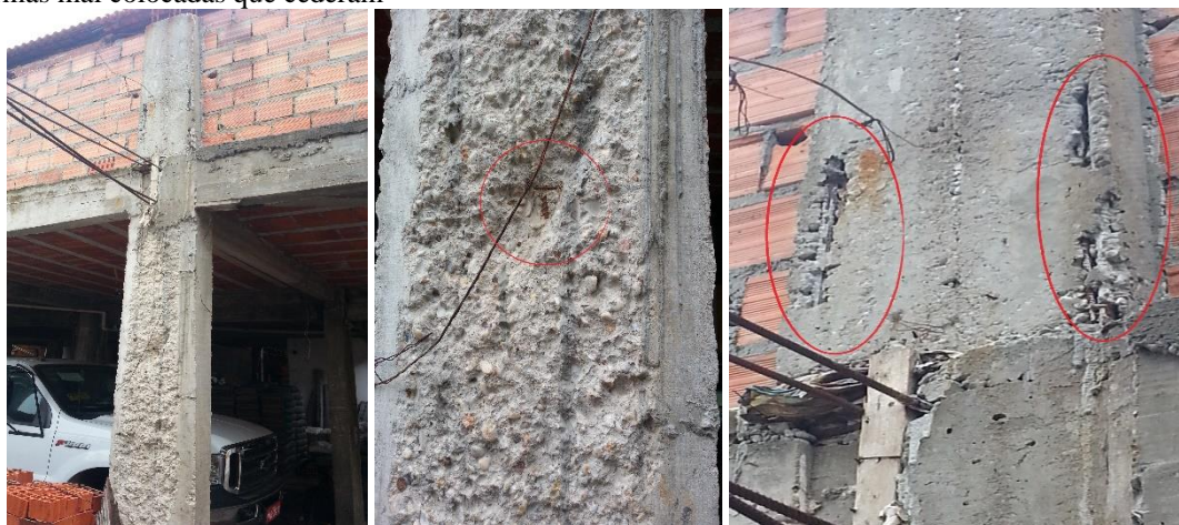
Figura 1: a) Visão geral do pilar 40x15 com armaduras expostas sem revestimento adequado, segregação e fôrmas mal colocadas que cederam
