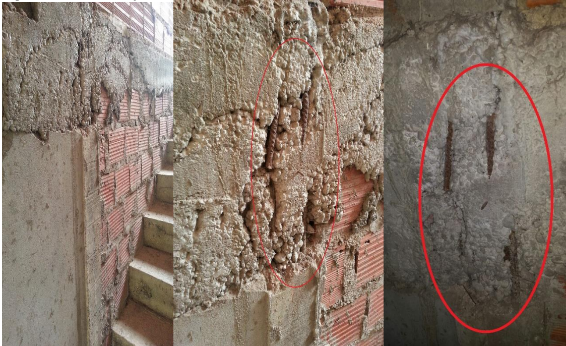
Figura 2: Pilar com segregação do concreto ocasionado por má execução, possivelmente por não ter respeitado as recomendações de lançamento do concreto e sem cobrimento adequado
